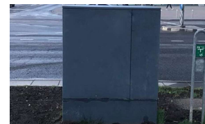
50 pav. Elektros skydinė. Nuotr. iš DO ARCHITECTS archyvo
