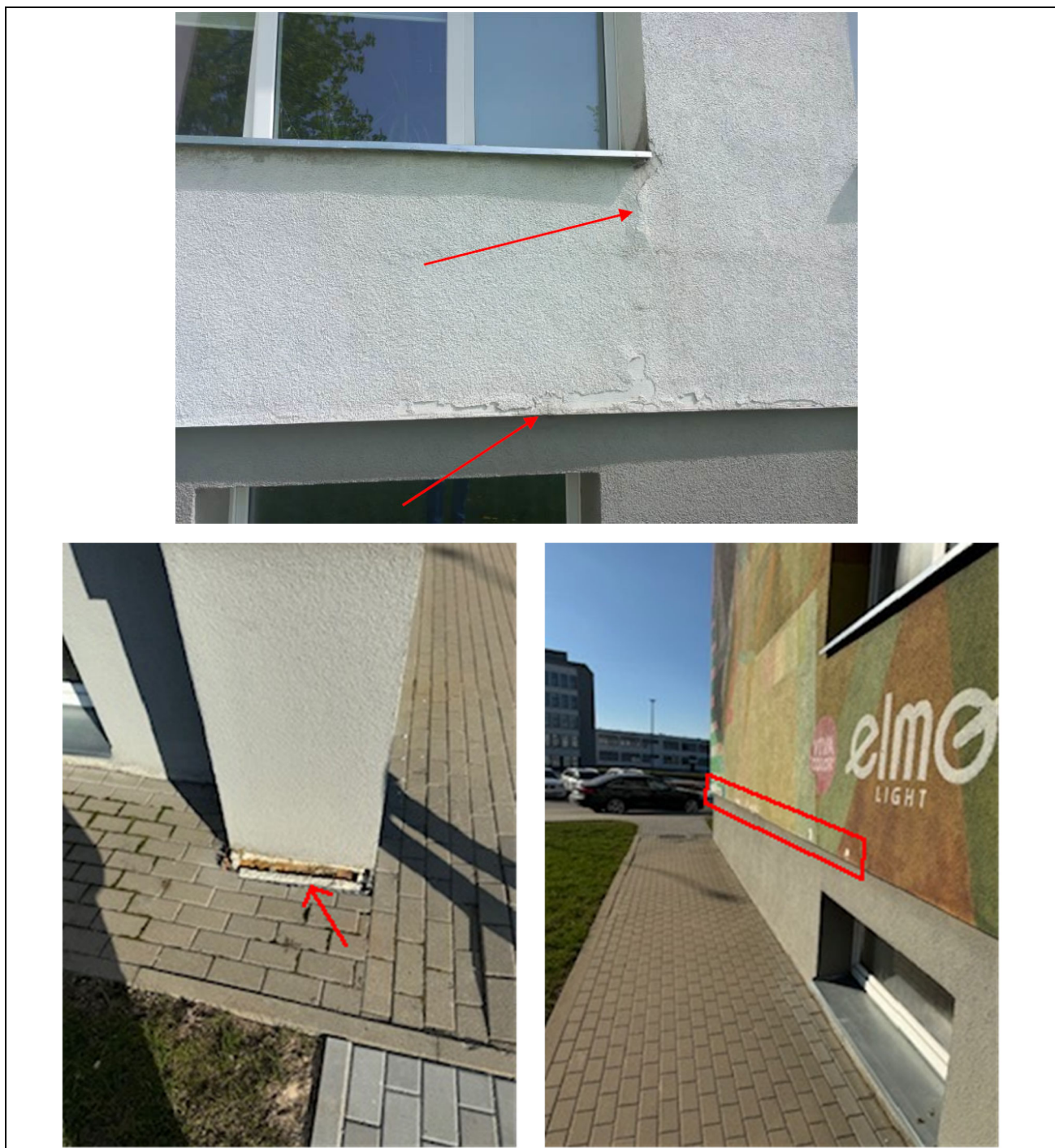
2 pav. cokolio esamos būklės fotofiksacija
