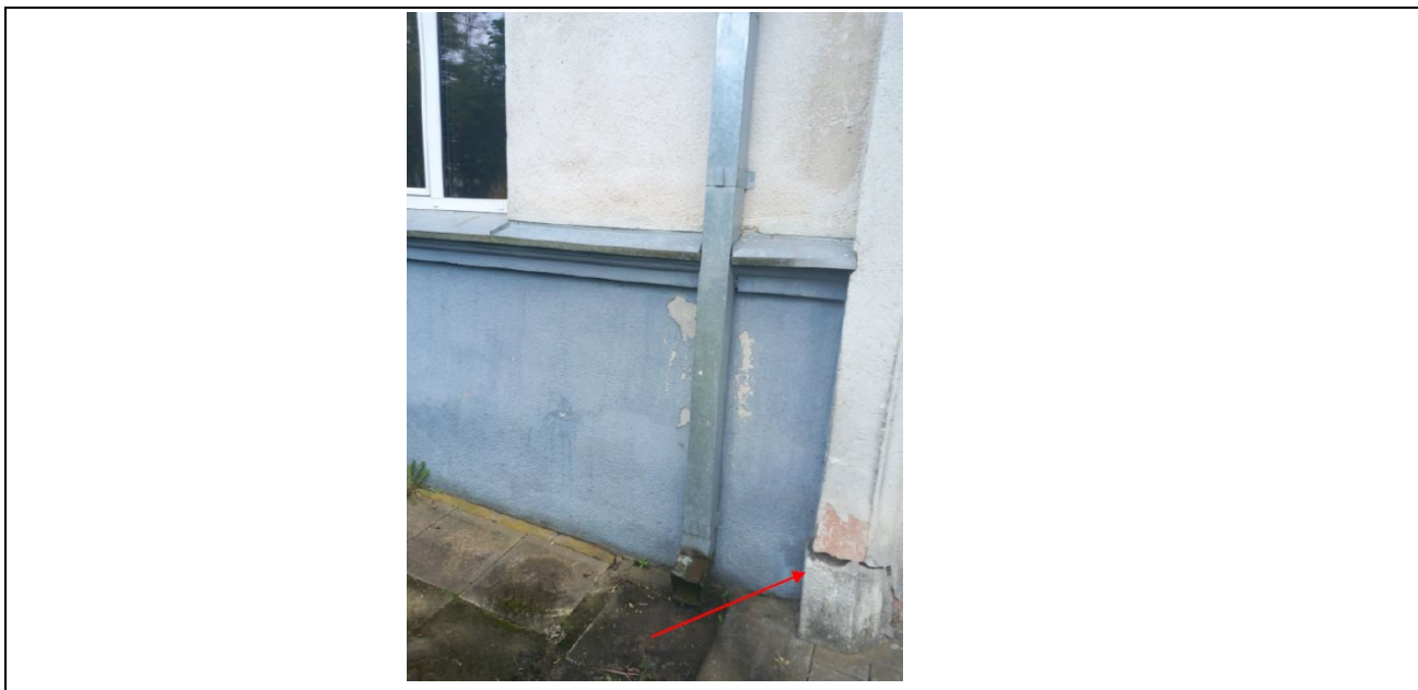
1 pav. cokolio esamos būklės fotofiksacija
