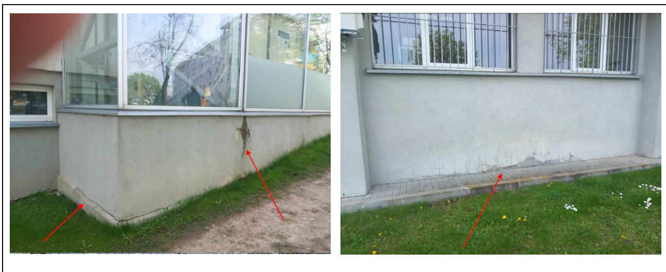
3 pav. fasado esamos būklės fotofiksacija
