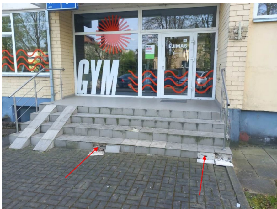
2 pav. lauko laiptų esamos būklės fotofiksacija
