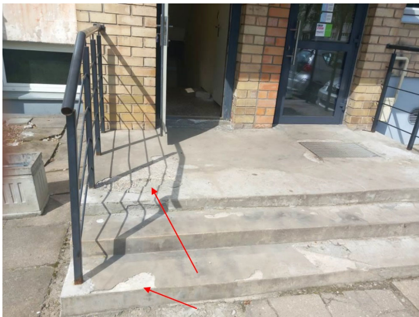
1 pav. lauko laiptų esamos būklės fotofiksacija
