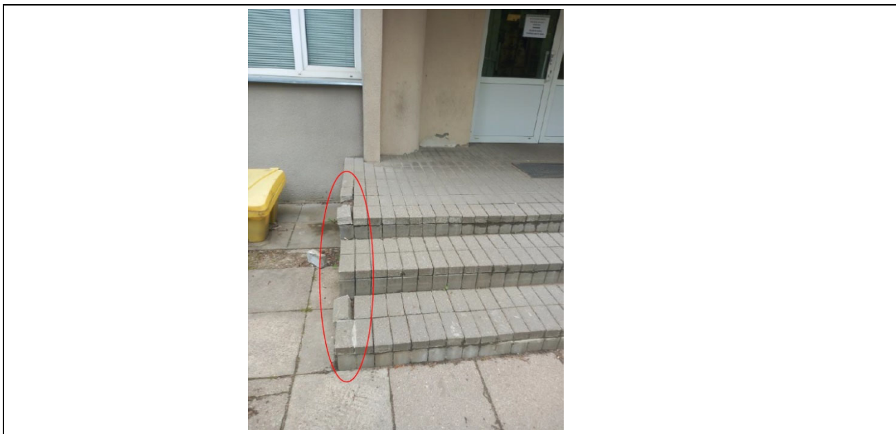
1 pav. lauko laiptų esamos būklės fotofiksacija
