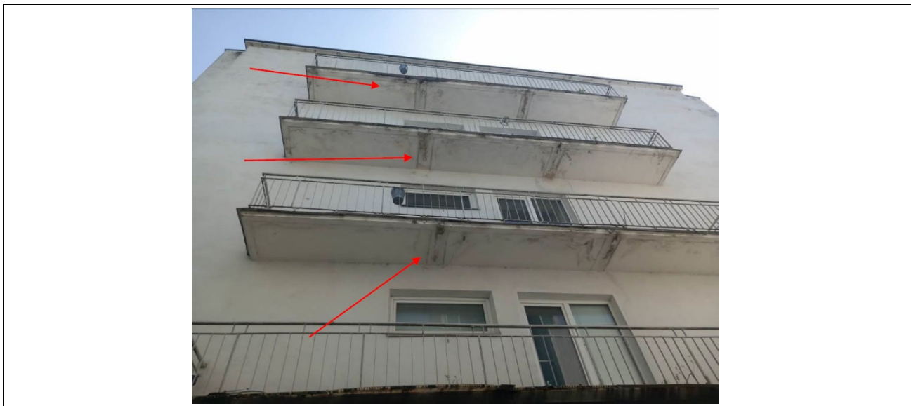
2 pav. balkonų esamos būklės fotofiksacija
