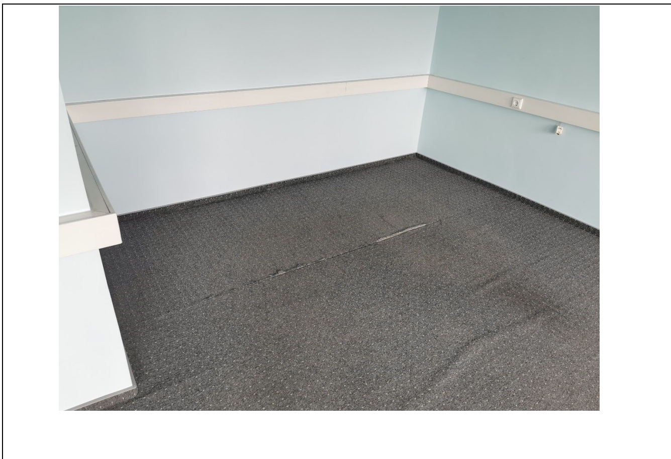
4 pav. 503 kab. kiliminės dangos fotofiksacija
