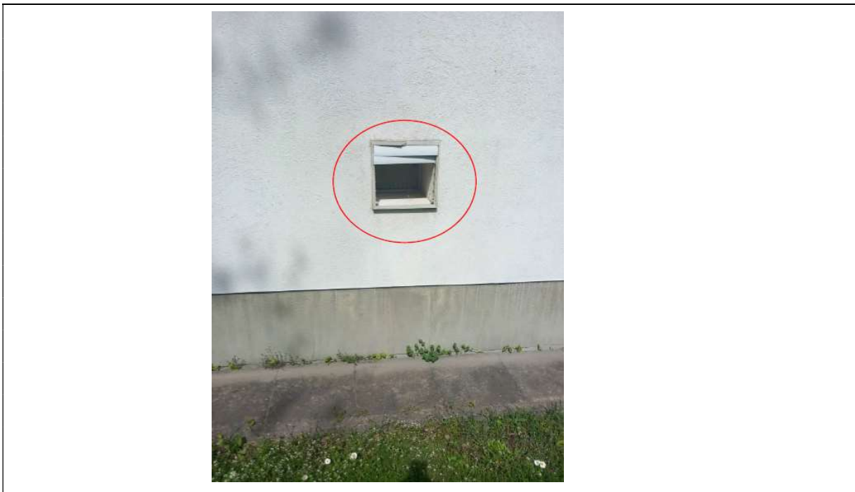
4 pav. ventiliacijos grotelių esamos būklės fotografacija
