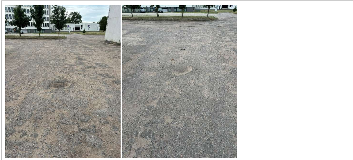
2 pav. remontuojamų duobių esamos būklės fotofiksacija
