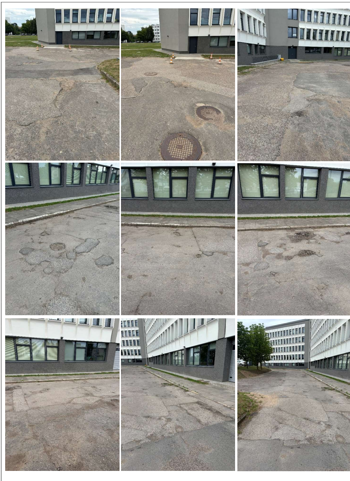
2 pav. remontuojamų duobių esamos būklės fotofiksacija
