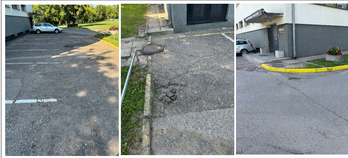
6 pav. remontuojamų duobių esamos būklės fotofiksacija
