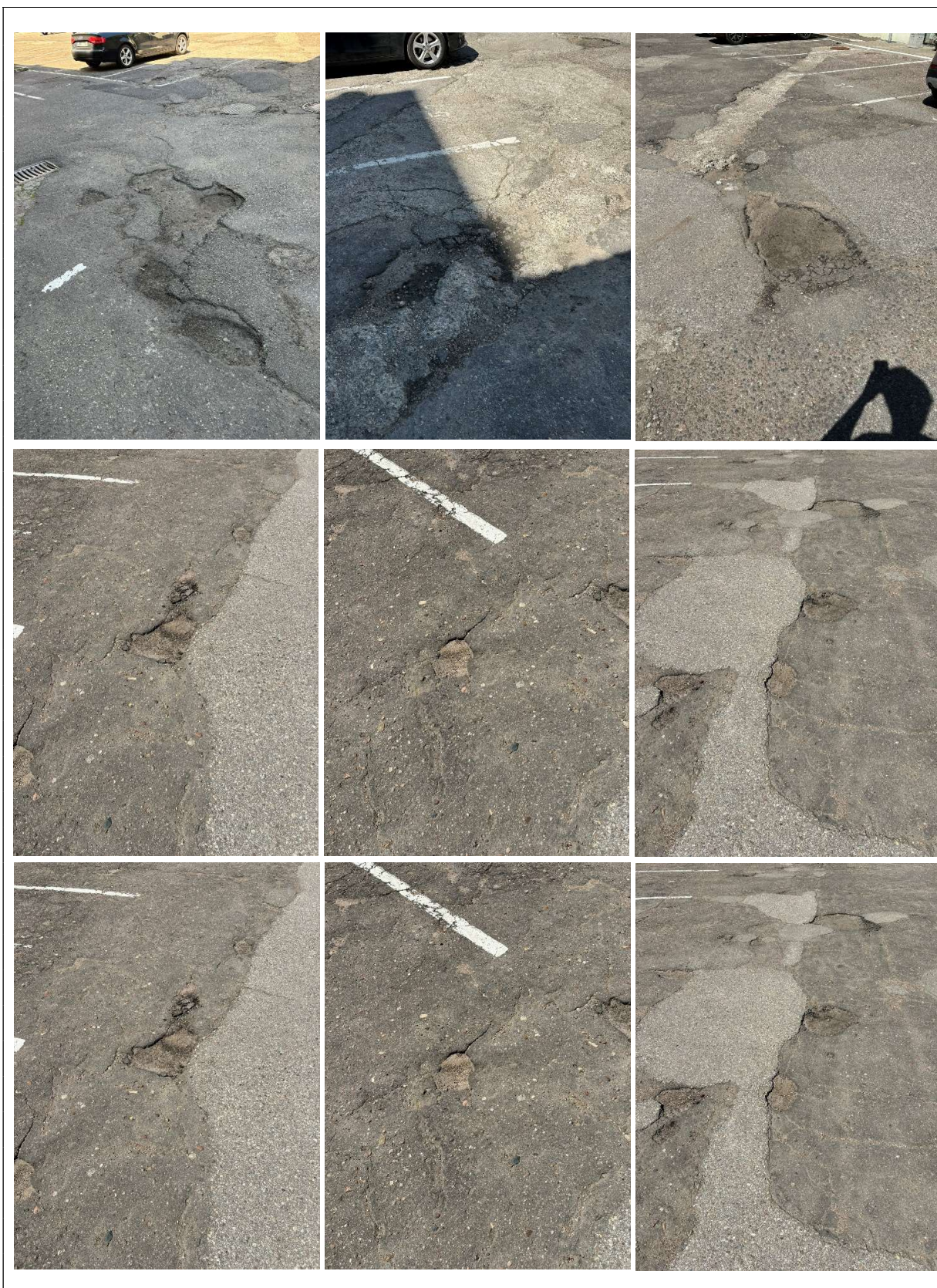
4 pav. remontuojamų duobių esamos būklės fotofiksacija
