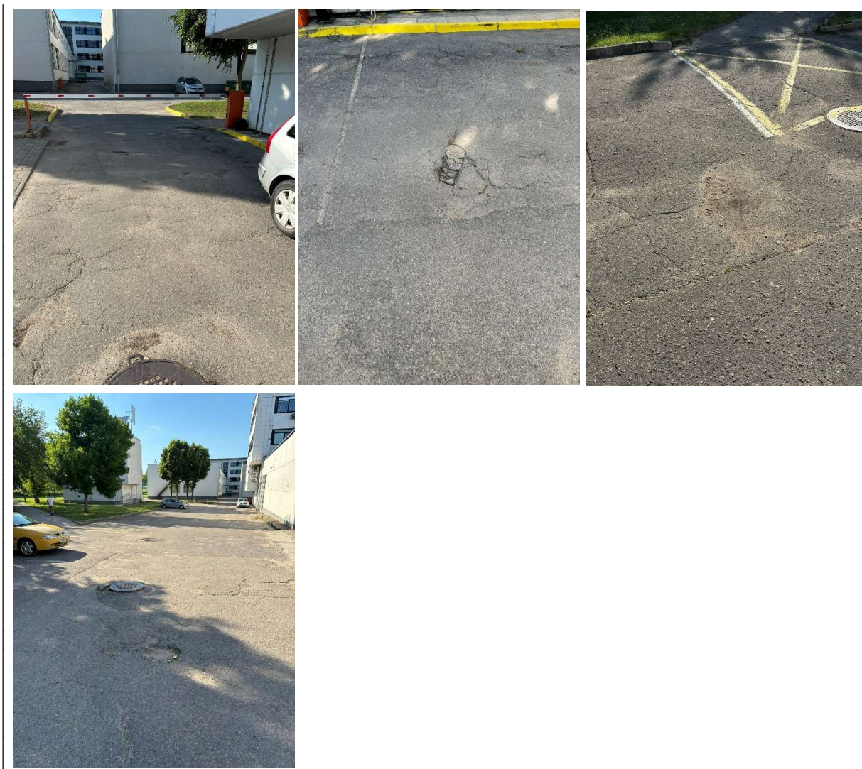
2 pav. remontuojamų duobių esamos būklės fotofiksacija
