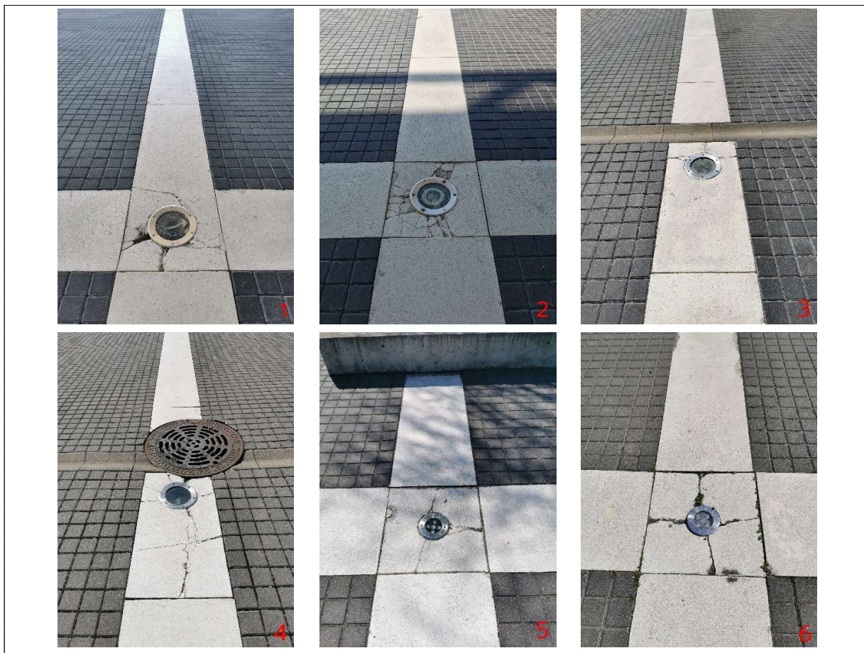
5 pav. plytelių esamos būklės fotofiksacija
