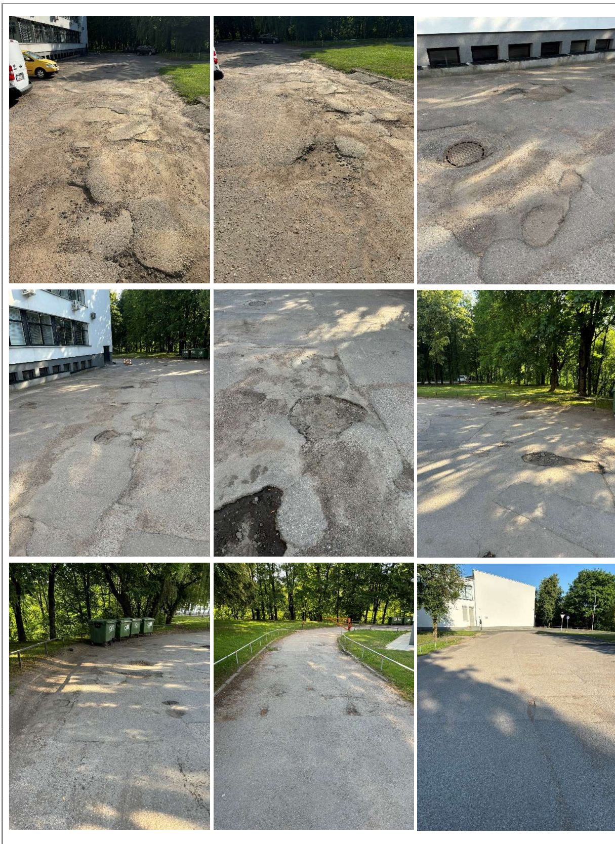
2 pav. remontuojamų duobių esamos būklės fotofiksacija
