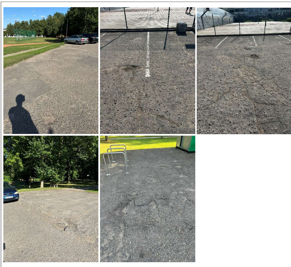
9 pav. remontuojamų duobių esamos būklės fotofiksacija
