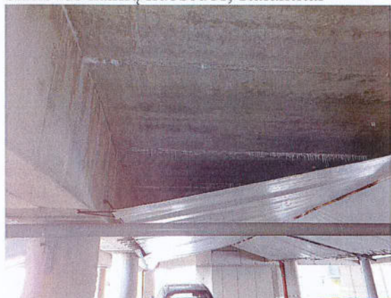
j) stalaktitai siūlėse tarp plokščių
