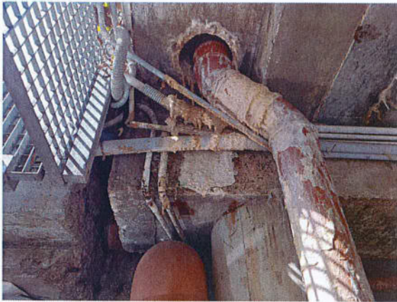
e) nesandari paviršinio vandens nuvedimo sistema, gelžbetoninėms konstrukcijoms būdingos erozijos ir korozijos pažaidos
