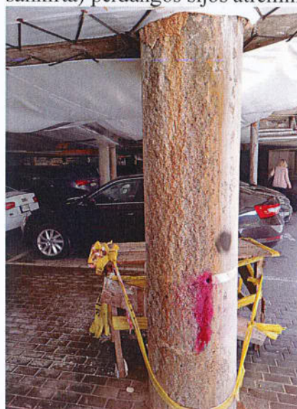
d) būdinga antrojo (betono karbonizacijos) ir trečiojo (sulfatinė) pavidalo korozija; kolonos karbonizacijos gylio nustatymas
