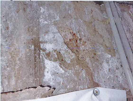
i) betono karbonizacijos pažeistas apsauginis betoninis sluoksnis atplėštas
