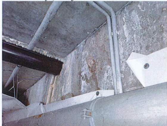
h) betono paviršiuje susidariusios balkšvos kalkių nuosėdos (stalaktitai)
