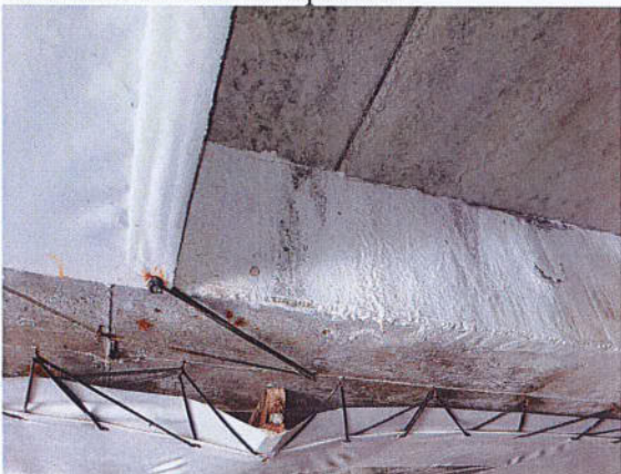
y) pirmo pavidalo betono korozija
