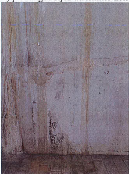
c) nekokybiškai įrengta atraminės sienos (ašyje A) betonavimo technologinė siūlė
