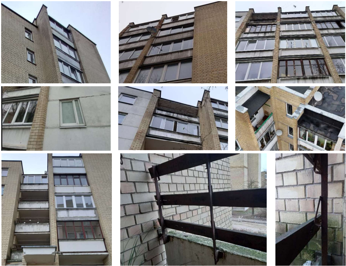
3 pav. Nusidėvėjęs fasadas - plytų mūras paveiktas erozijos, mūro siūlės apirusios, , sieninės plokštės suaižėjusios, tarplokštinės siūlės nusidėvėjusios. Ant fasado sumontuotos antenos, oro kondicionierius.
