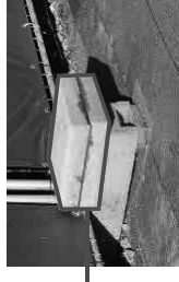
Netinkamas tvirtinimas. Tvoros turi būti tvirtos, stabilios, neišsikišti į pėsčiųjų praejimus. Tvoros tvirtinimas turėtų būti statybvietėje, netrukdyti pėsčiųjų eismo.
