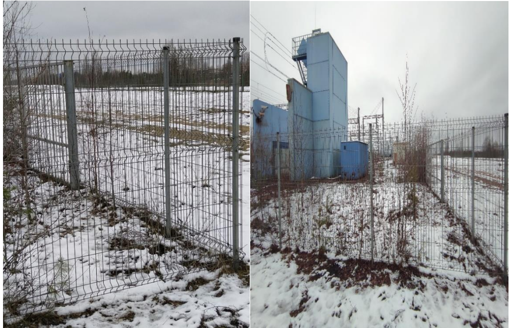
Kenos geležinkelio stoties rentgeno kontrolės sistema aptverta apsaugine perimetro tvora su varteliais (tvora aliumininė, segmentinė, ažūrinė, tvoros stulpai)(Techninės specifikacijos 3.1.7 p.)
