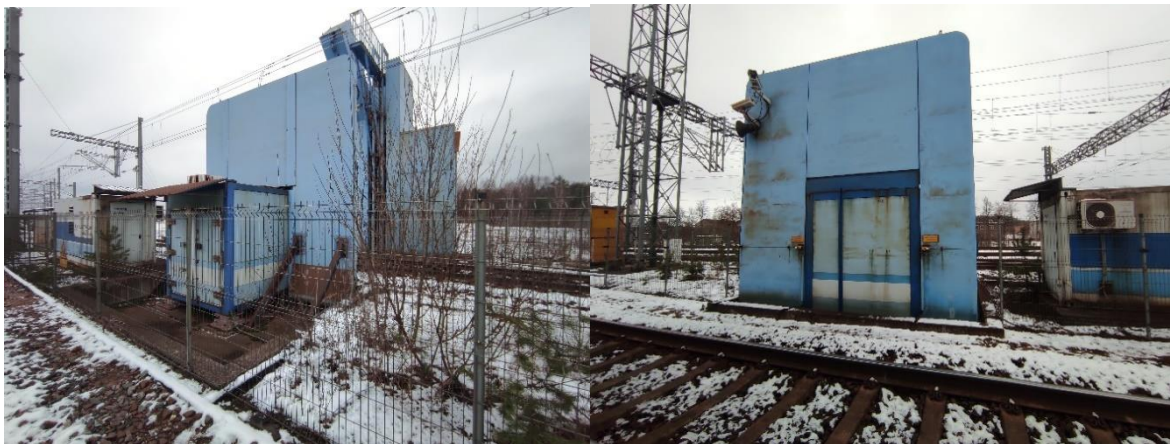
Jonizuojančios spinduliuotės įrenginys-generatorius, sumontuotas atskiroje patalpoje (Metalo konstrukcija su vedinimo sistema ir cinkuotos geležies pastoge, gelžbetonio pamatai, ant išorinės konstrukcijos sienos sumontuoti vaizdo stebėjimo ir rentgeno kontrolės valdymo elementai, konstrukcijos sienų tarpai pripildyti smėlio). (Techninės specifikacijos 3.1.1 p)
