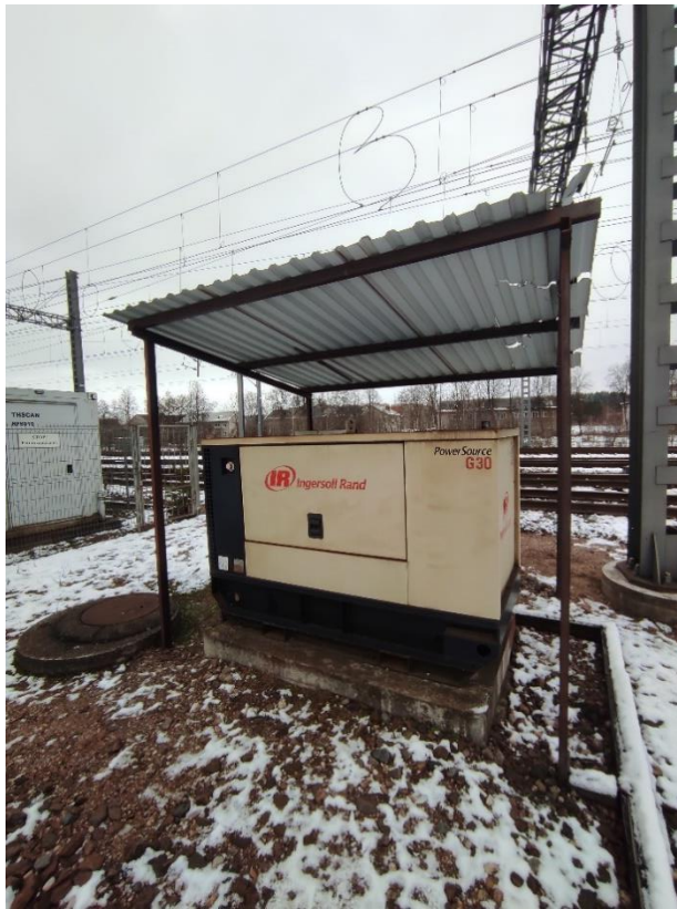
Dyzelinis generatorius su pastoge (cinkuota skarda, geležinė pastogės konstrukcija, gelžbetonio pamatai) (Techninės specifikacijos 3.1.4)
