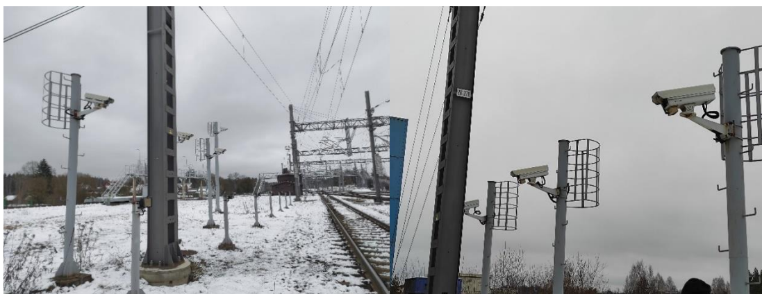
Vaizdo stebėjimo sistema (vaizdo kameros sumontuotos ant metalinių stulpų -4 vnt. , stulpai įbetonuoti. Taip pat vaizdo kameros sumontuotos ant bokšto ir jonizuojančio spinduliuotės įrenginio-generatoriaus patalpų) (Techninės specifikacijos 3.1.2. p. , 3.1.1 p., 3.1.8 p.)
