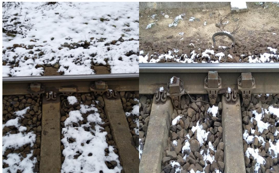
Radiacinės saugos zonos apsaugos įranga (sumontuoti ant betoninio pagrindo, stulpeliai su davikliais- 7 vnt., vertikalūs davikliai - 4 vnt., davikliai ant bėgių – 4 vnt.) (Techninės specifikacijos 3.1.3. p)
