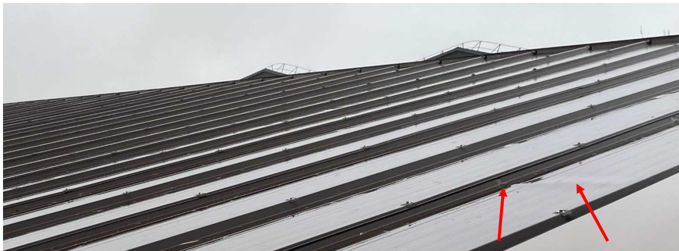
11 pav. Deformuota šlaitinio stogo plokštė
