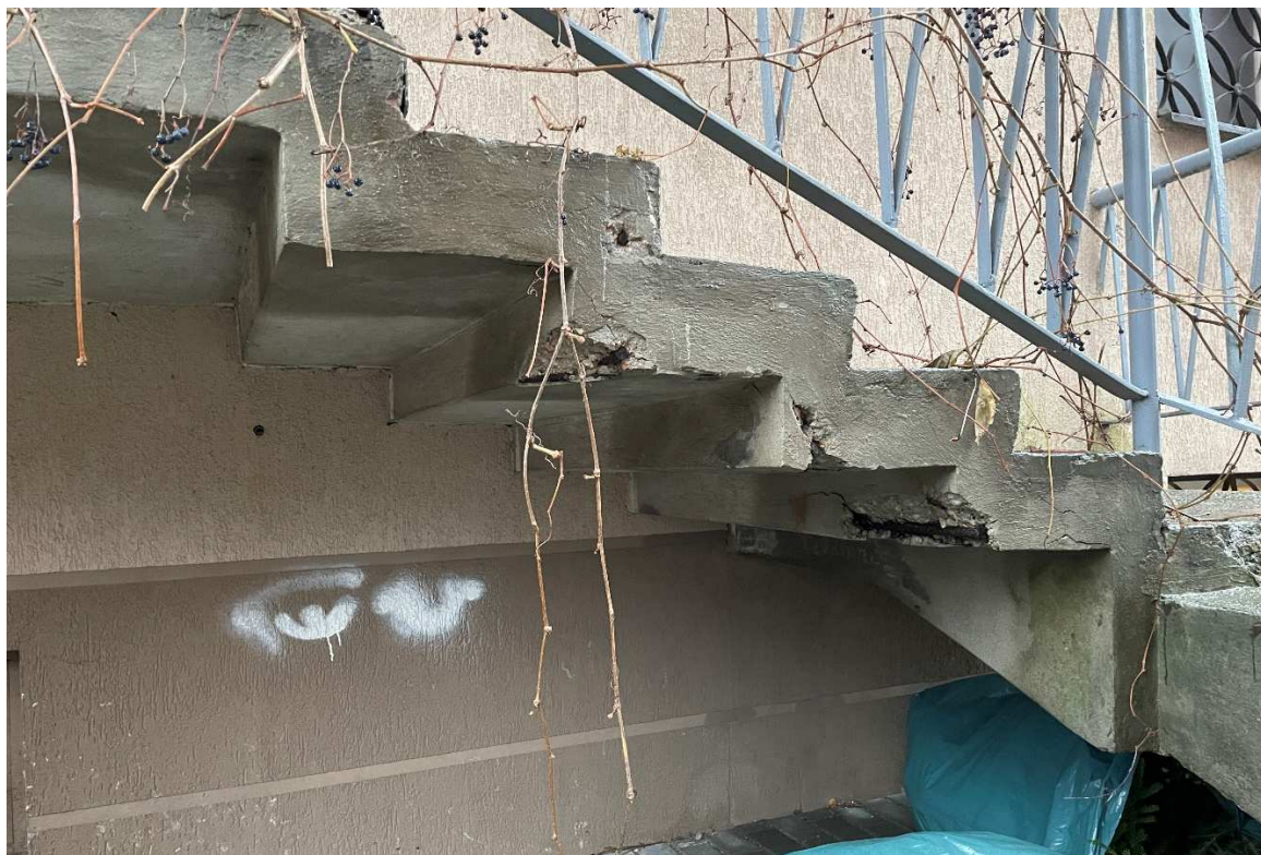
10 pav. Korozijos pažeisti lauko laiptai
