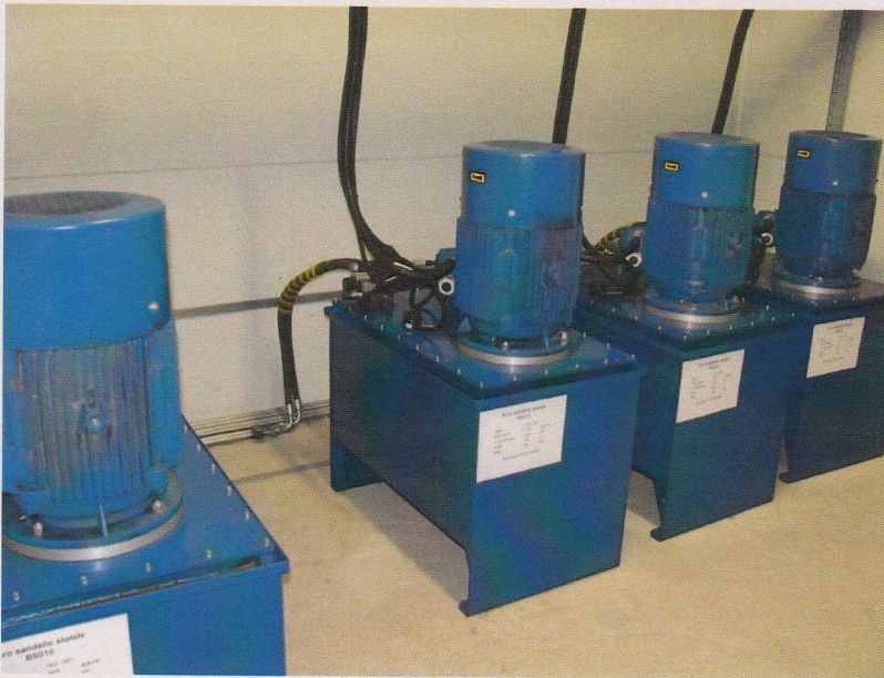
1.2.3. BVŠK – 1elektrostatinio filtro hidrostotelė. Kiekis – 1 hidrostotelė. Tipas HYD/X Art.4122-00429. Elektros variklio galingumas 1,3 kW; slėgis 60 bar. Bendras hidrostotelės vaizdas:
