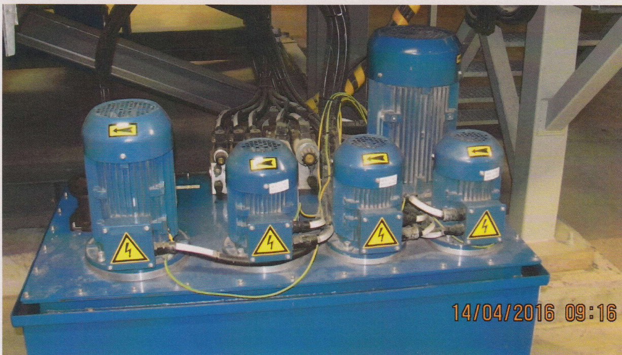
1.3.2. BVŠK-4 kuro sandėlio hidrostotelės. Kiekis – 3 hidrostotelės (3 hidro stotelės po 1 hidro siurbį). Tipas 18,5-393. Variklių galingumas 15 kW. Slėgis 180 bar. Bendras hidrostotelių vaizdas:
