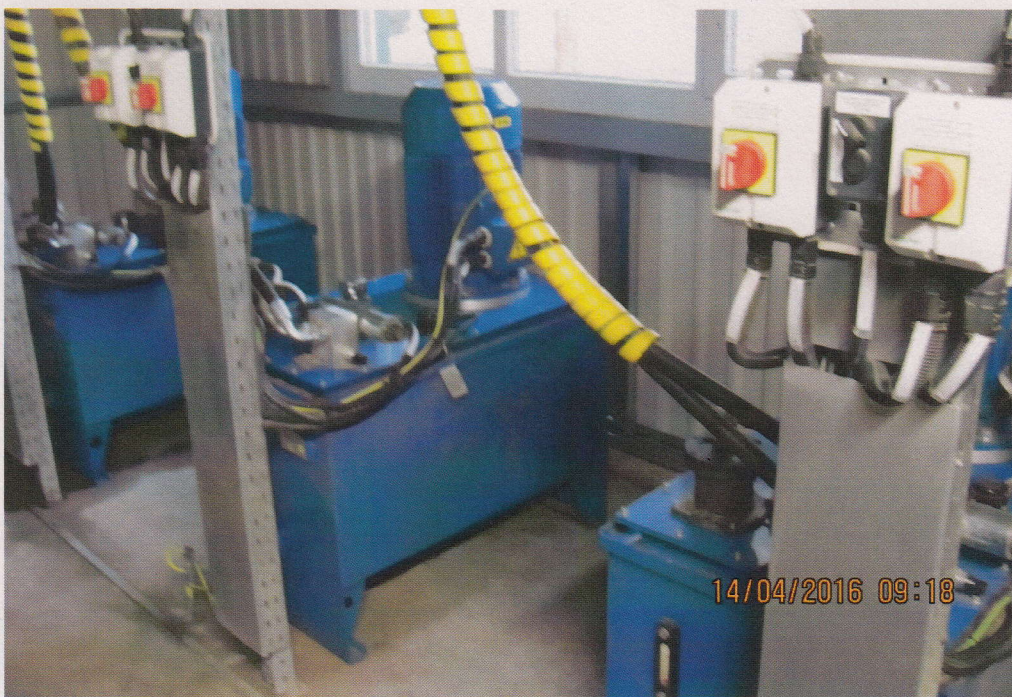
1.3.3. BVŠK – 4 elektrostatinio filtro hidrostotelė. Kiekis – 1 hidrostotelė. Tipas HYD/X Art.4122-00429. Elektros variklio galingumas 1,3 kW; slėgis 60 bar. Bendras hidrostotelės vaizdas:
