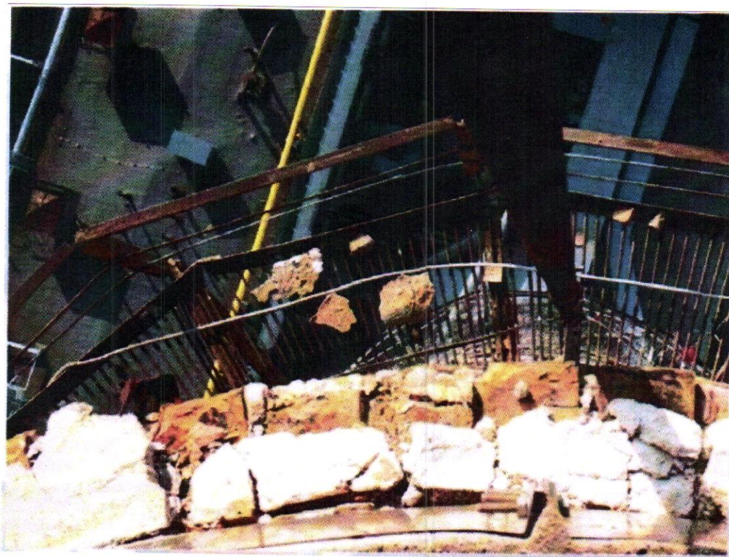
Viršūnės „galvutės“ karnizo mūro erozija (45 proc.): plytos suirę nutrupėję 3-50 mm, mūro siūlės 5-20 mm pločio suirę 5-220 mm gylio.
