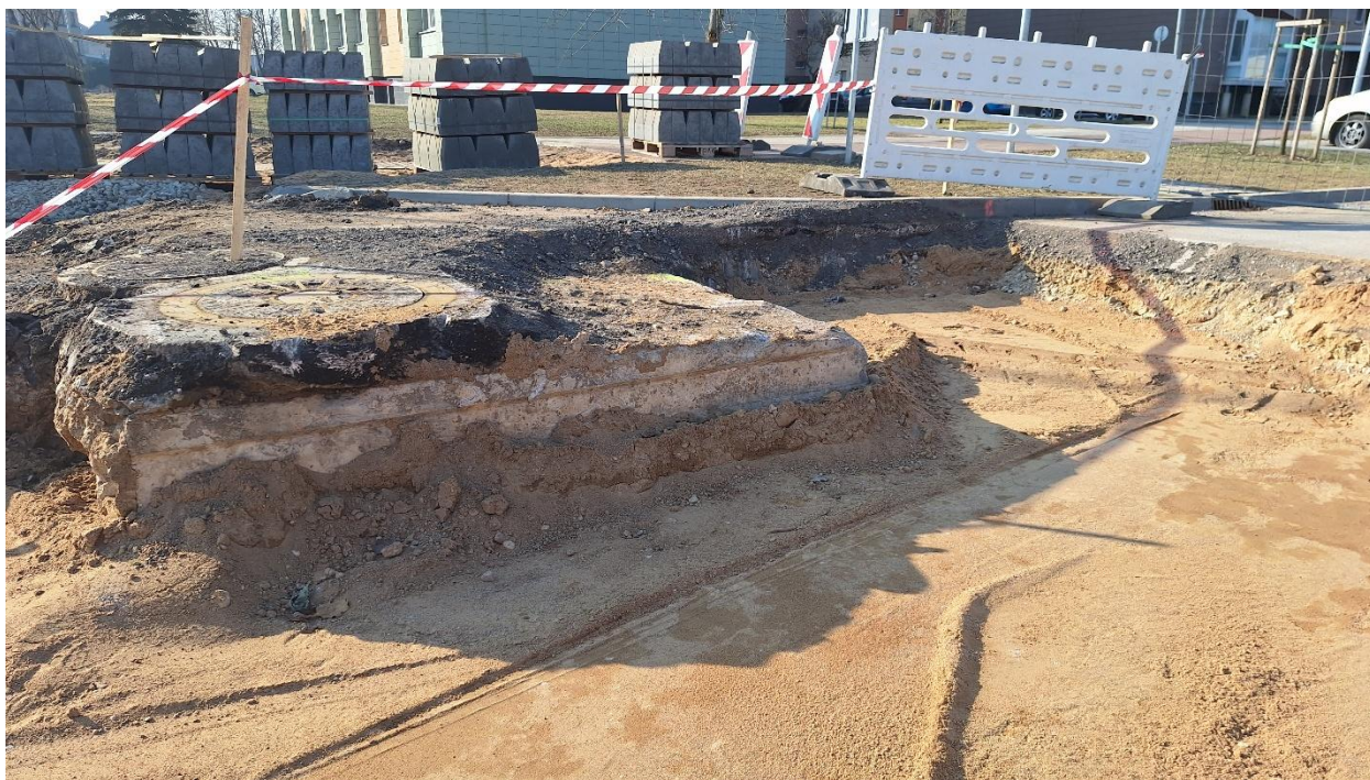
2pav. Kauno-Masčio gatvių sankryžoje Pk 2+50 esama vandentiekio kamera
