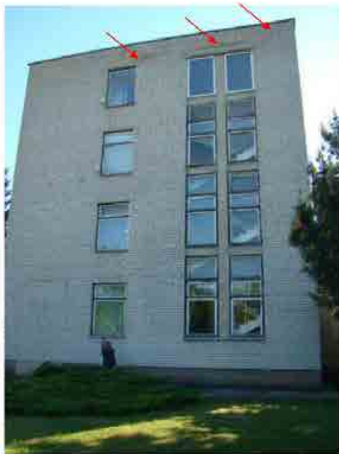
2. Pastato fasadas tarp ašių B-E; drėgmės dėmės virš 4-to aukšto langų; įstrižas plyšys mūro sienoje ties parapetu dešiniajame kampe
