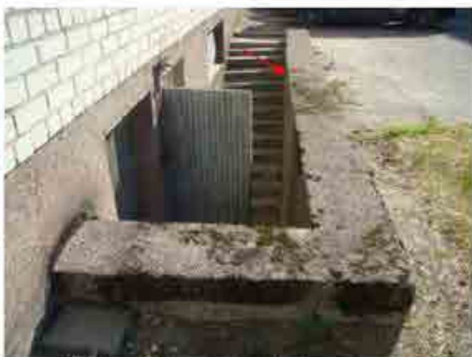
14. Grunto išstumta atraminė siena, sumontuota iš pamatų blokų su nesandariomis siūlėmis
