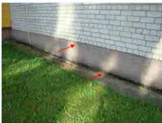
6. Įtrūkinimas sienos cokolinėje dalyje; nusėdusi nuogrinda
