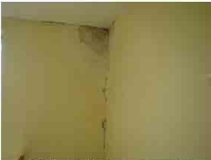
19. Drėgmės dėmė ties denginiu – sienos peršalimo požymis; įtrūkinas tarp statmenų laiptinės sienų ašyse 6-D*
