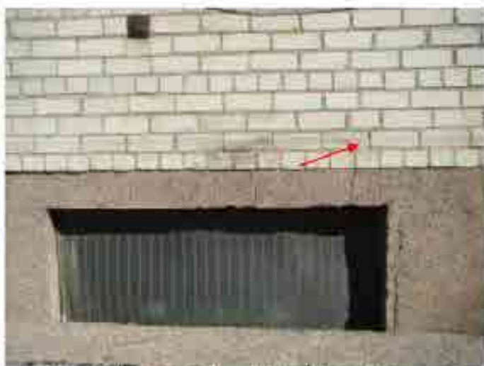
8. Įtrūkinimas mūro sienoje iki gelžbetoninės sąramos
