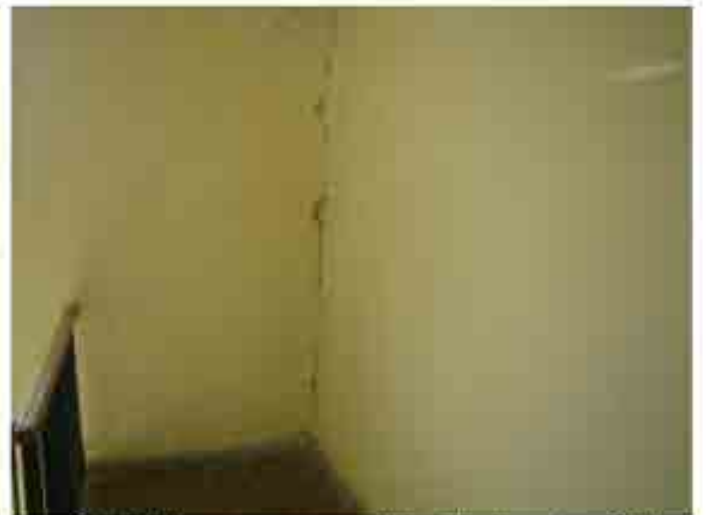
20. Įtrūkinas tarp statmenų laiptinės sienų ašyse 6-D*
