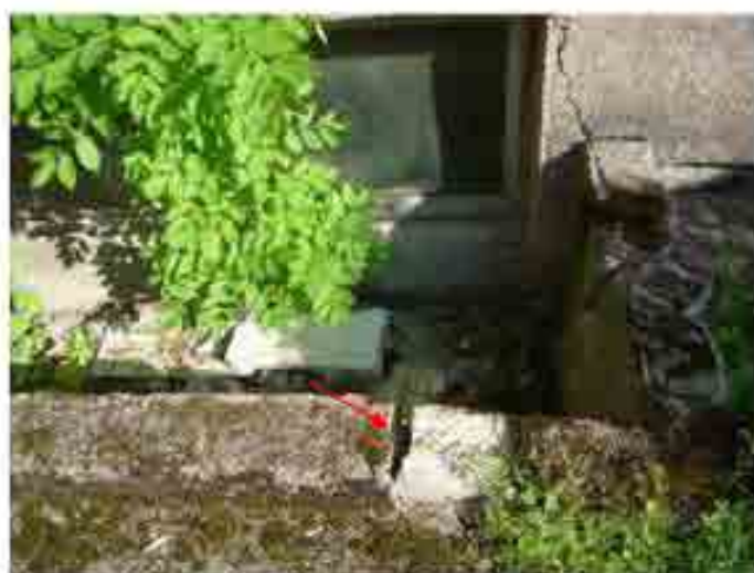
15. Grunto išstumta priedubės siena: priedubė neprižiūřeta, neišvalyta ir dėl to kaupianti drėgmę prie pastato sienos
