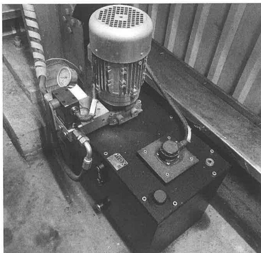
7 pav. Elektrostatinio filtro žertuvų hidrostotis
