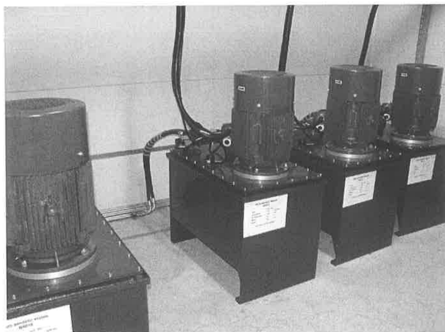
1 pav. Druskininkų filialo katilo BVŠK-1 kuro sandėlio hidrostotys. Kiekis – 4 hidrostotys (4 hidrostotys po 1 hidro siurblių). Tipas 18,5-393. Variklių galingumas 18,5 kW slėgis, 200 bar
