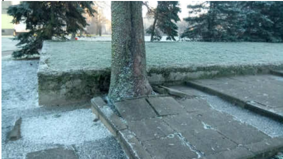
Medis nr. 21 pasviręs į atraminės betoninės sienutės pusę . Ir šaligatvio vaizdas.
