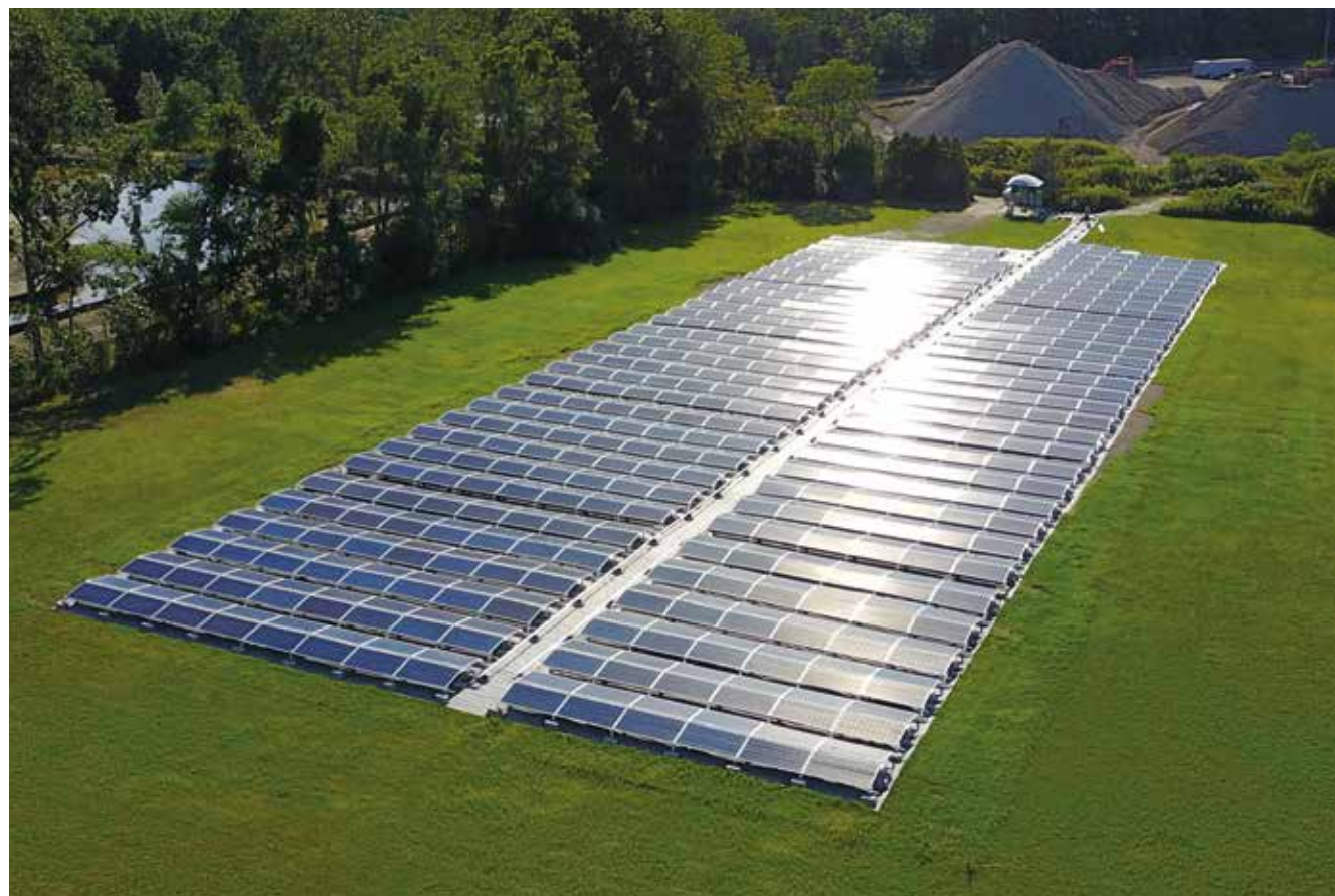
USA / 250 KWP / G+
