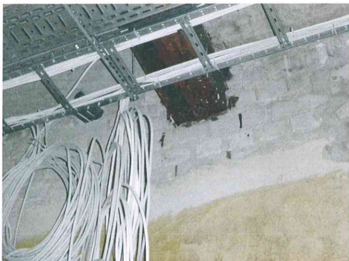
9 pav. Plieninės sijos pradėjusios koroduoti. Neįrengta betoninė ar gelžbetoninė pagalvė.
