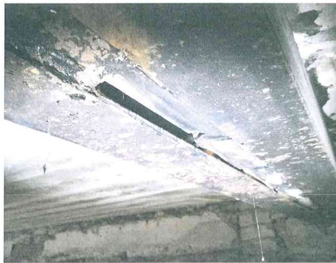
10 pav. Plieninės sijos pradėjusios koroduoti.
