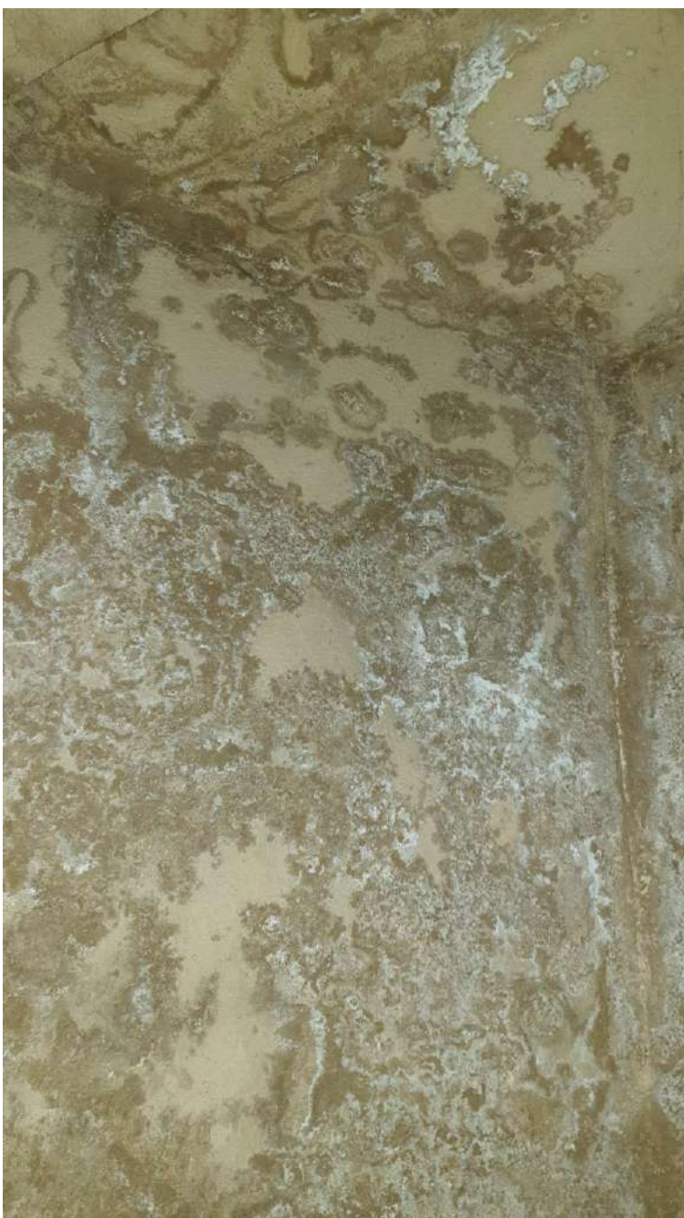
11 Pav. Sienos konstrukcijos defektai
