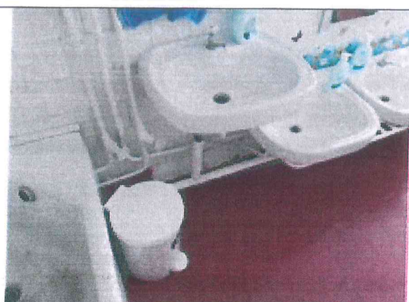
Pav. 50 Nusidėvėjusios pastato vandentiekio ir nuotekų sistemos.
