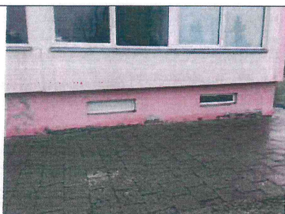
Pav. 4 Nuo cokolinės pastato atšokęs apdailinis sluoksnis, vietomis, kur nubyrėjęs tinkas, matoma armatūra.
