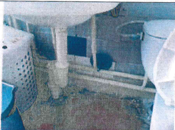
Pav. 47 Nusidėvėjusios pastato vandentiekio ir nuotekų sistemos.
