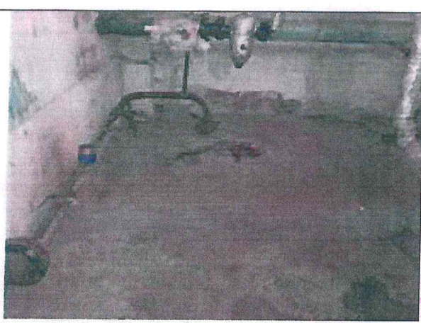
Pav. 52 Nusidėvėjusios pastato vandentiekio ir nuotekų sistemos.
