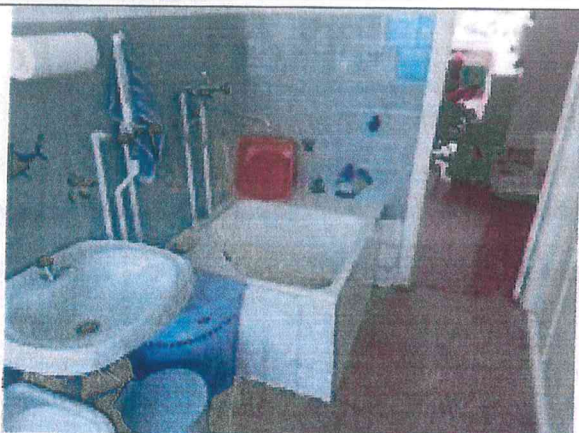
Pav. 49 Nusidėvėjusios pastato vandentiekio ir nuotekų sistemos.
