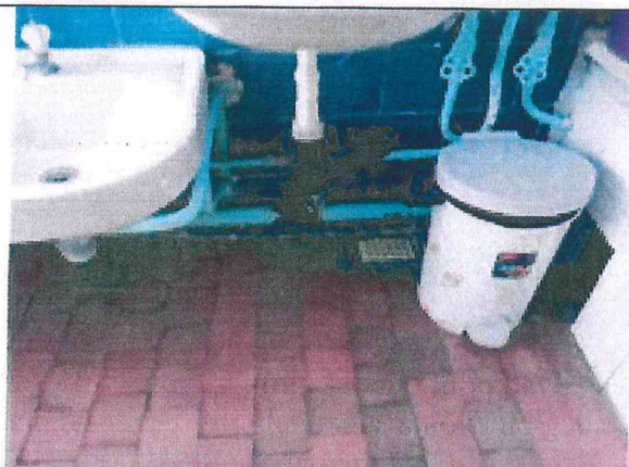
Pav. 48 Nusidėvėjusios pastato vandentiekio ir nuotekų sistemos.
