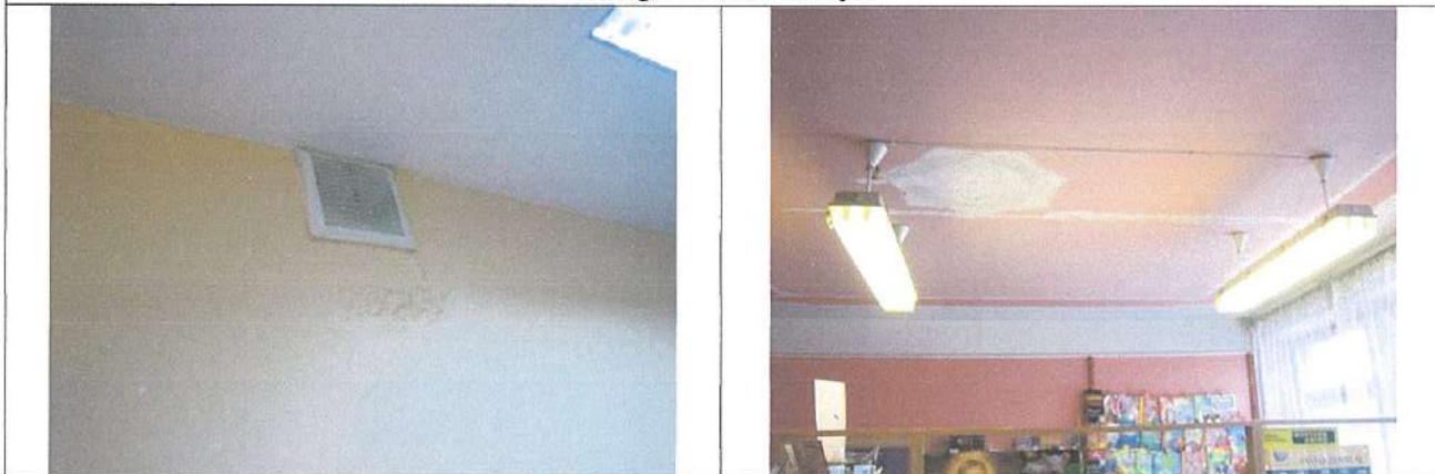
Dėl drėgmės pažeista pastato vidaus apdaila
