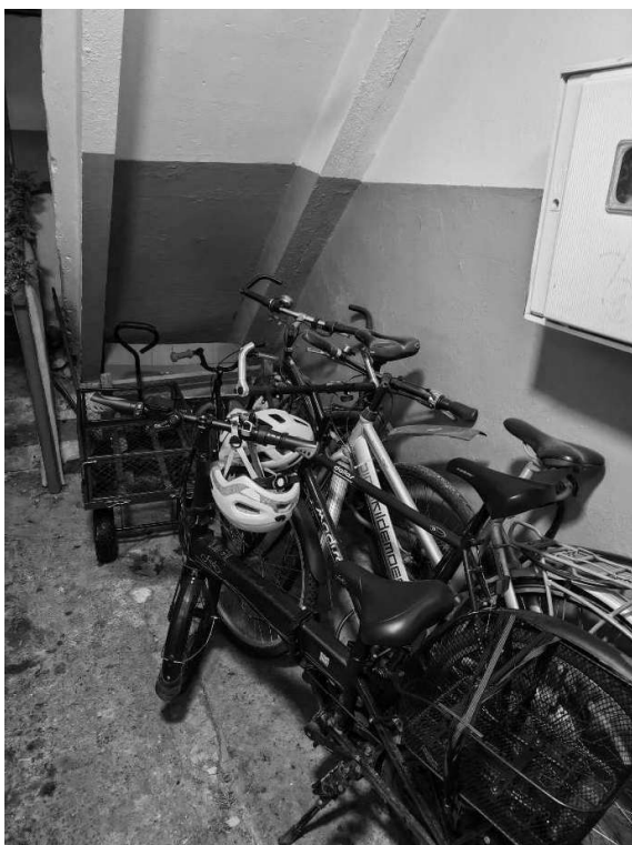
6 pav. 2.2. p. pastebėti laiptinės defektai.
