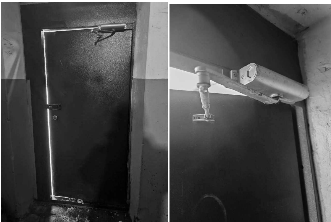
5 pav. 1.5. p. pastebėti durų, langų defektai.
