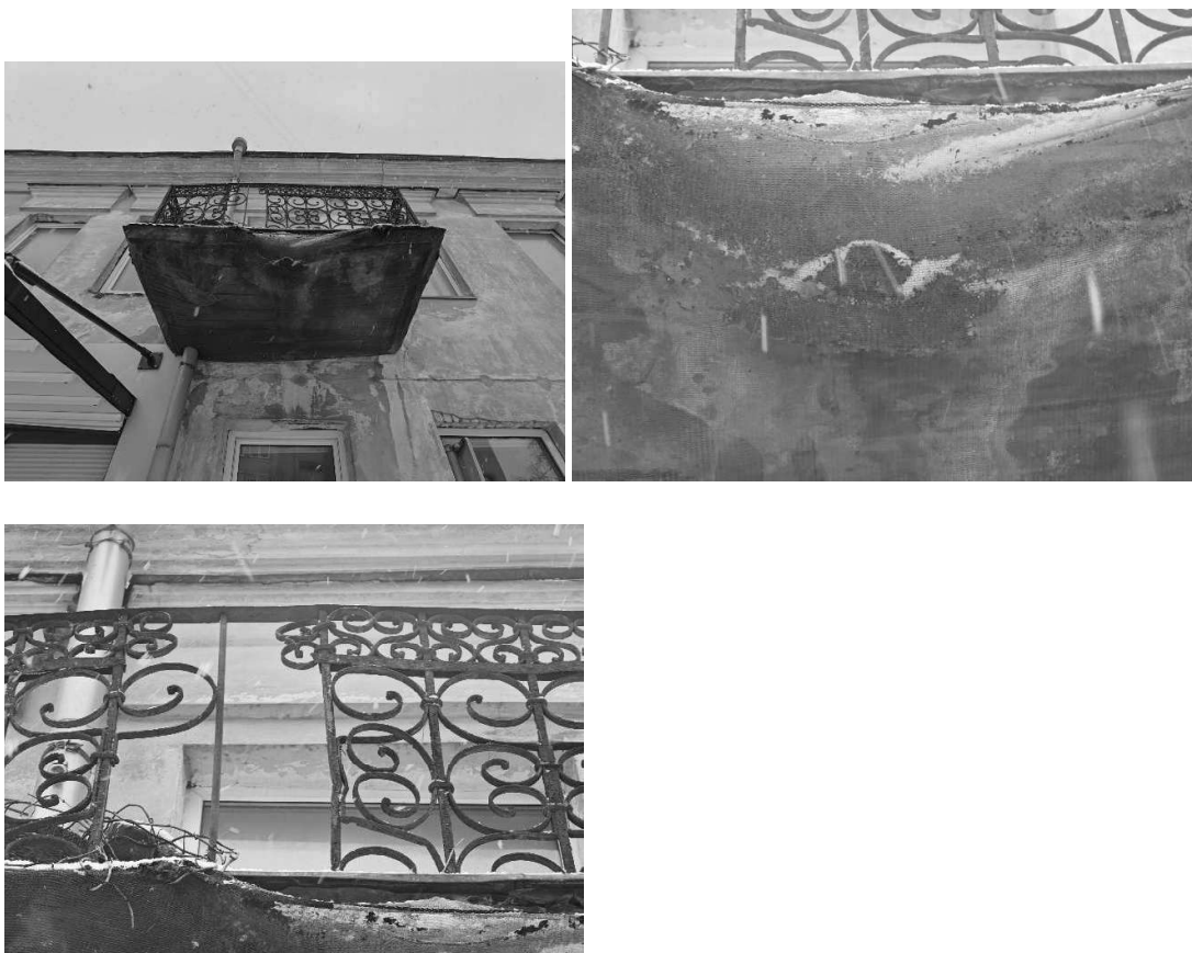
4 pav. 1.4.p. pastebėti balkonų defektai.
