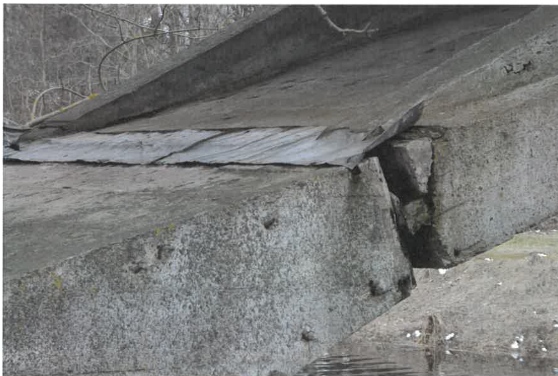
Pav. 9 Tilto centrinės arkos galinės atramos su betono korozijos ir nuoskily pažaidomis vaizdas
