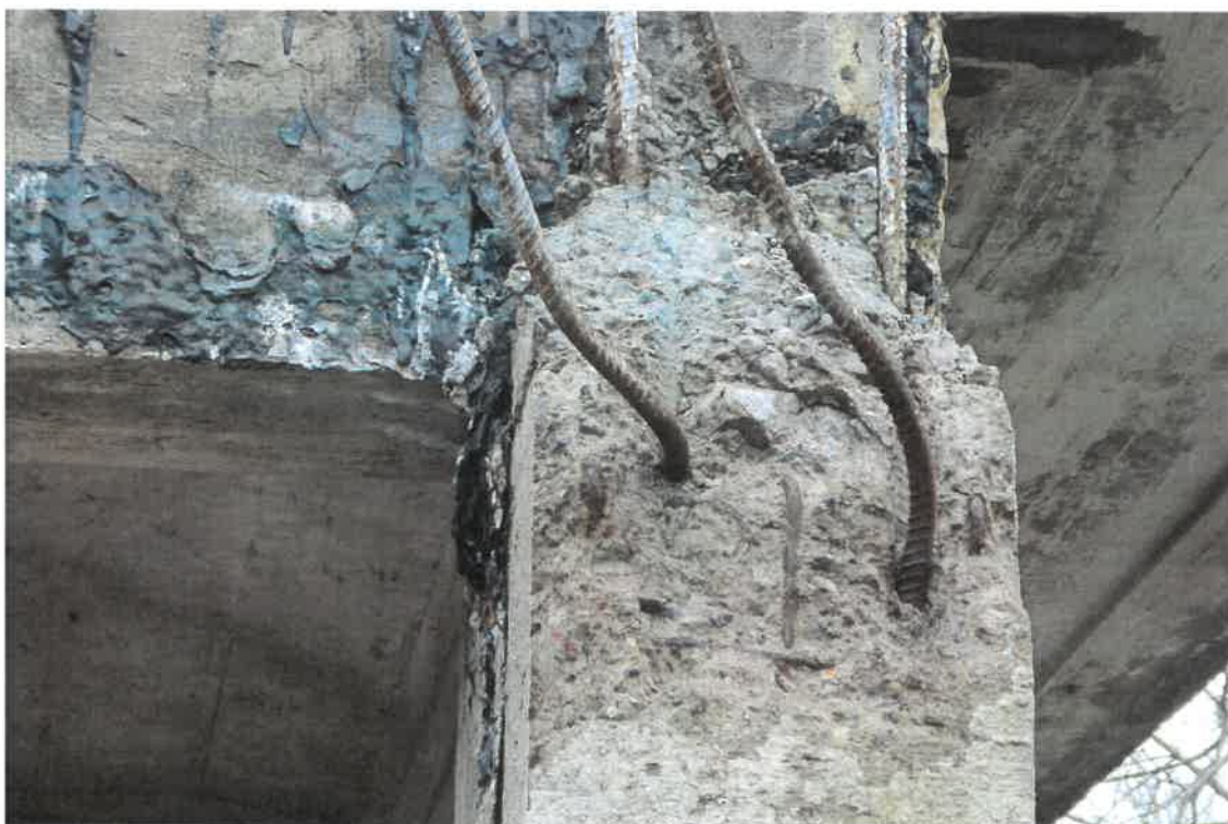
Pav. 10 Tilto galinės sijos atramos kolonų krante atraminio mazgo su betono pažaidomis vaizdas
