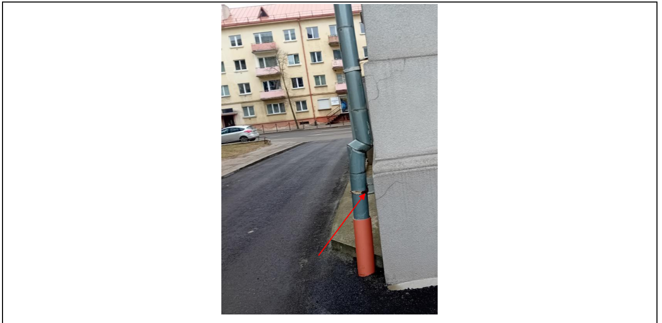
1 pav. lietvamzdžio esamos būklės fotografacija
