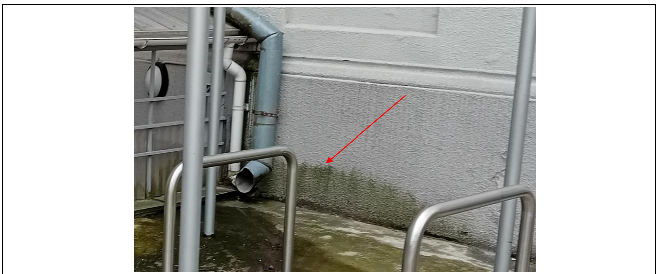
2 pav. lietvamzdžio ir fasado esamos būklės fotografacija
