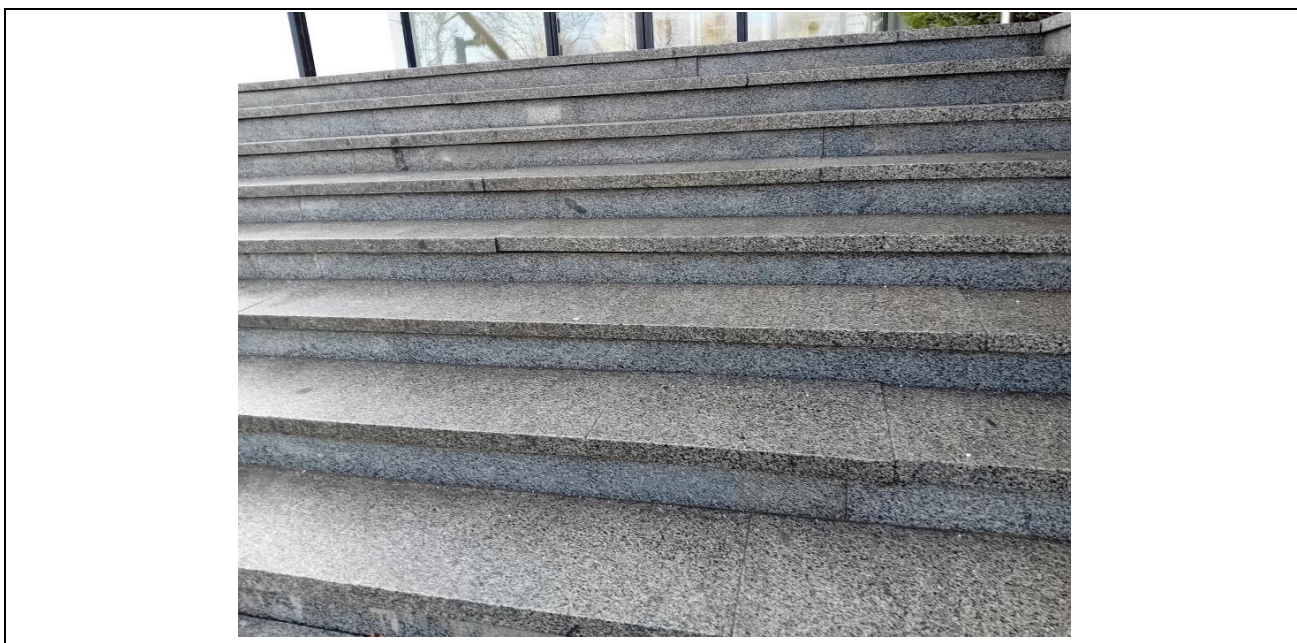
2 pav. laiptų pakopų esamos būklės fotografacija
