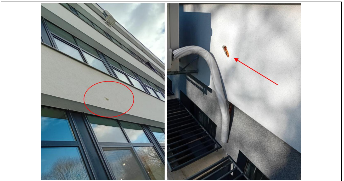
6 pav. fasado apdailos esamos būklės fotografacija
