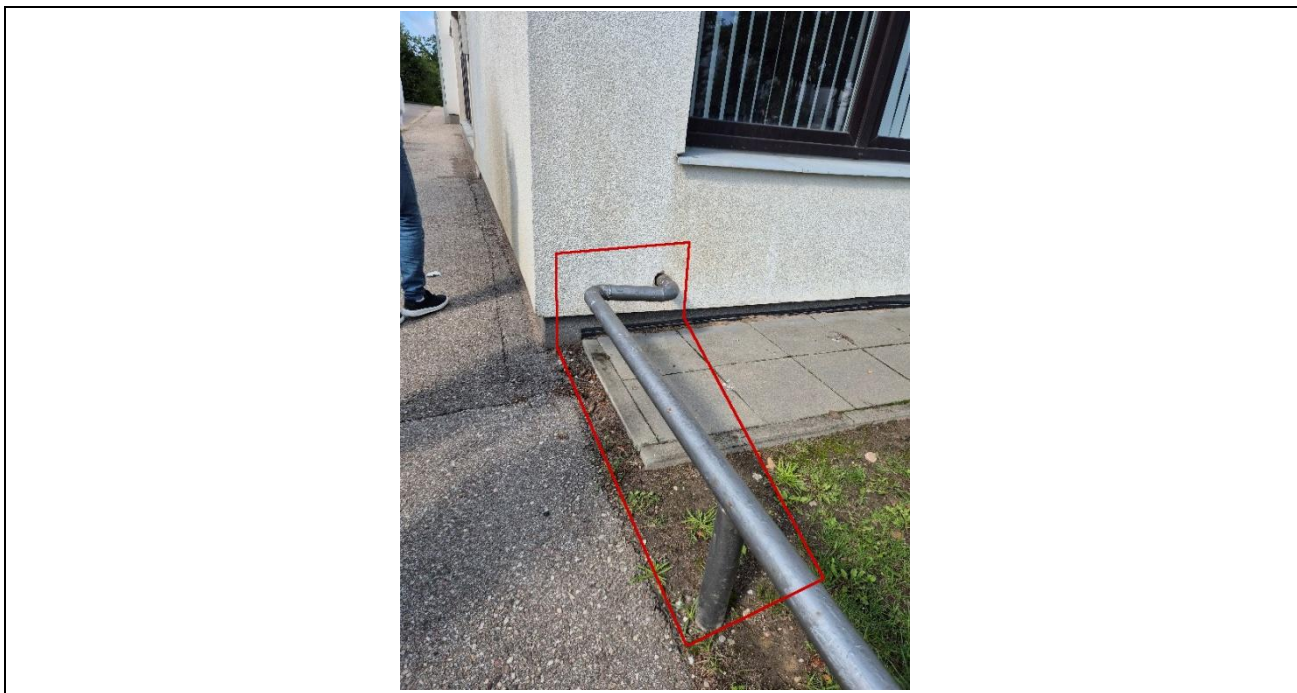
3 pav. vamzdžio esamos būklės fotografacija
