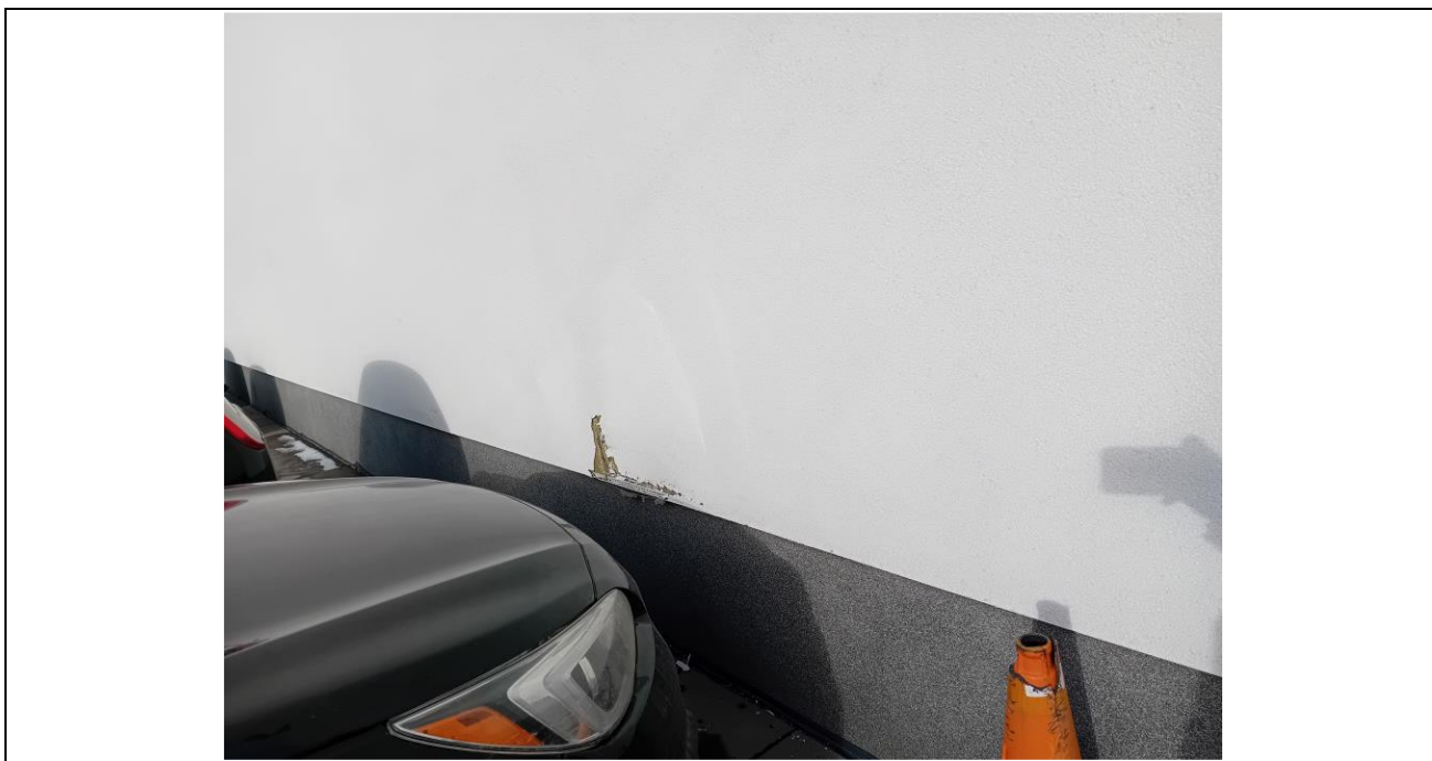
10 pav. fasado apdailos esamos būklės fotografacija
