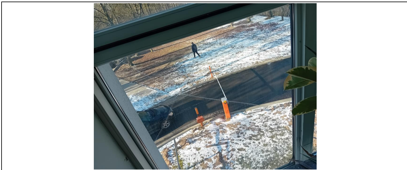
4 pav. lango esamos būklės fotografacija
