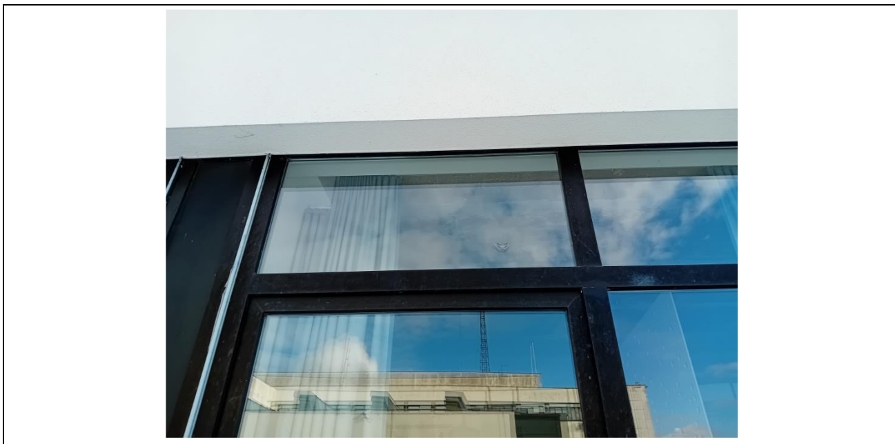
9 pav. lango esamos būklės fotografacija
