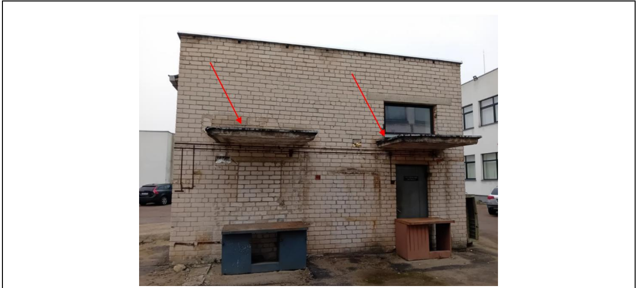
1 pav. betoninių stogelių esamos būklės fotografacija
