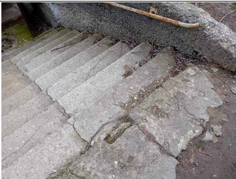
2 pav. laiptų pakopos esamos būklės fotografacija
