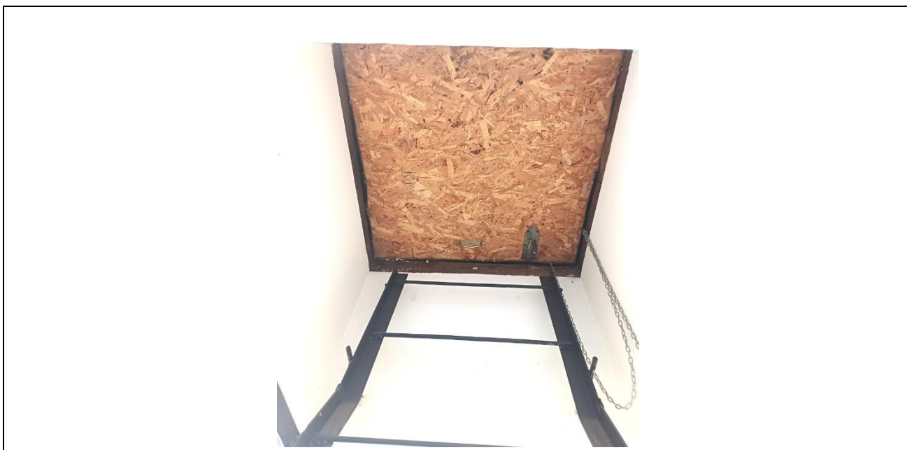
4 pav. stogo liuko esamos būklės fotografacija
