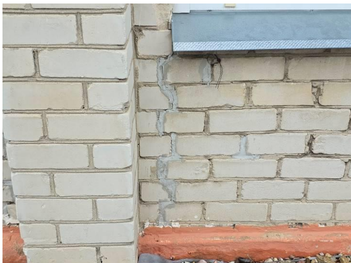
19. Plyšiai išorinėje sienoje ties patalpa 1-36.
