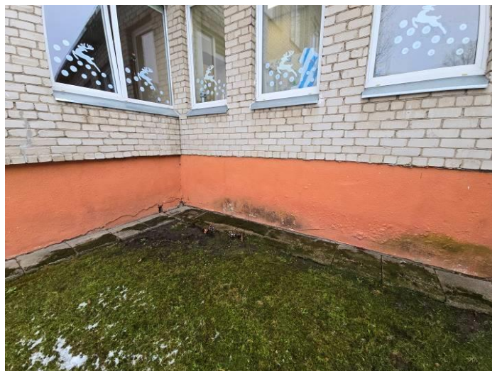
38. Šlampanti apsamanojusi cokolinė dalis dėl nepakankamo lietaus vandens nuvedimo.
