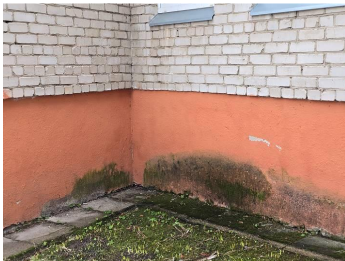
32. Šlampanti apsamanojusi cokolinė dalis dėl netinkamo lietaus vandens nuvedimo.
