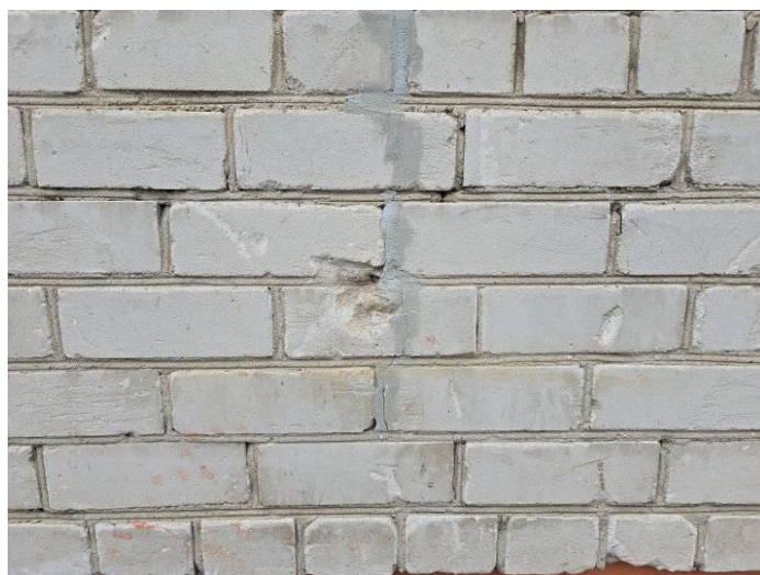
28. Plyšiai išorinėje sienoje ties patalpa 1-26 (rytinis fasadas).
