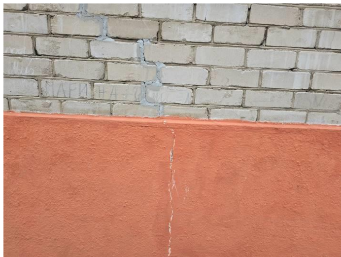
44. Plyšiai išorinėje sienoje ties patalpa 1-1 (rytinis fasadas).
