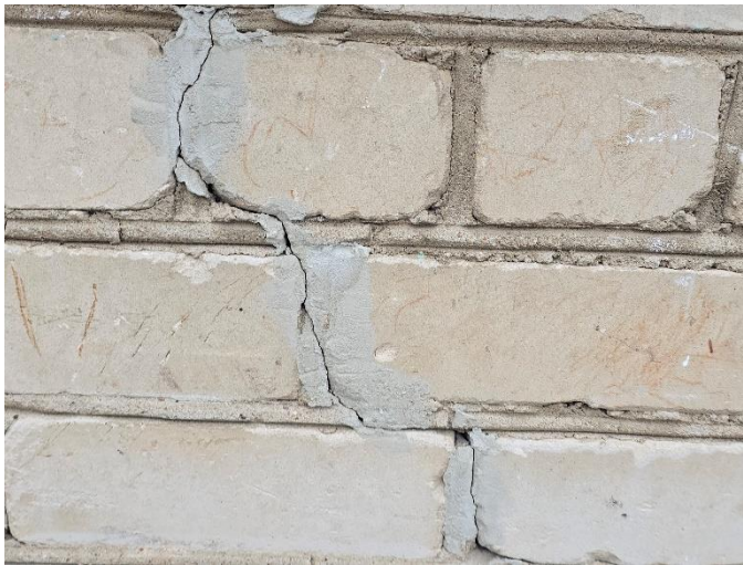
40 pav. Išorinėje mūrinėje sienoje matomas plyšys (pirmas aukštas).
