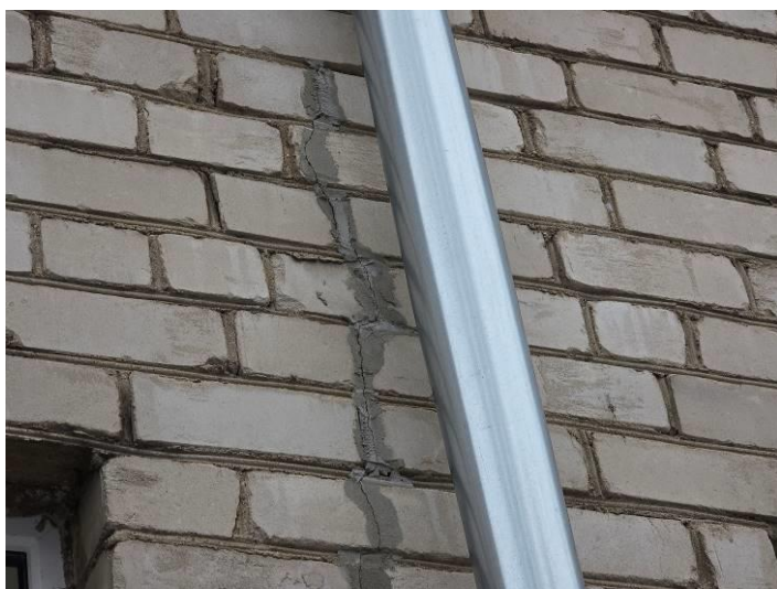
47. Plyšiai išorinėje sienoje ties patalpa 1-2 (pietinis fasadas).
