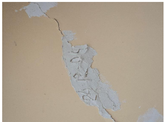
43 pav. Vidinėje skersinėje sienoje matomas plyšys, uždėtos markiruotės plyšio stebėjimui sutrūkusios (antro aukšto patalpa 3-1).
