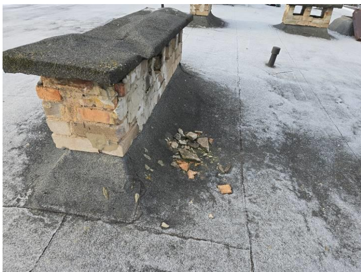
57. Erozijos veikiamas kaminėlio mūras.
