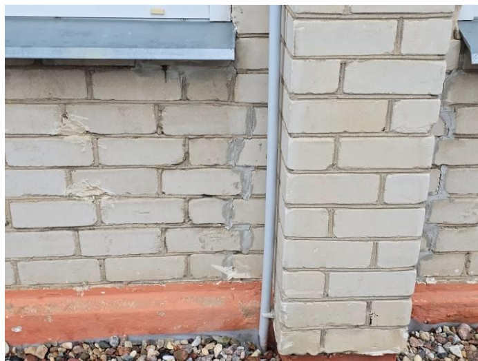
20. Plyšiai išorinėje sienoje ties patalpa 1-37.
