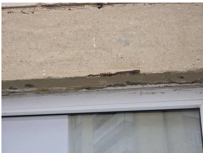
17. Atvira armatūra sąramoje ties pirmo aukšto patalpa 1-37 vakarinėje pastato pusėje.
