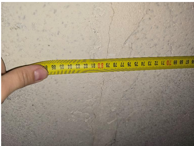
52 pav. Ties tarp perdangos plokščių esančiomis siūlėmis susiformavę įtrūkimai.
