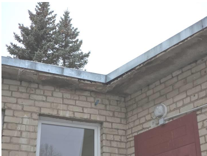
37. Dėl nepakankamo apskardinimo šlampanti karnizo plokštė, matoma betono korozija.
