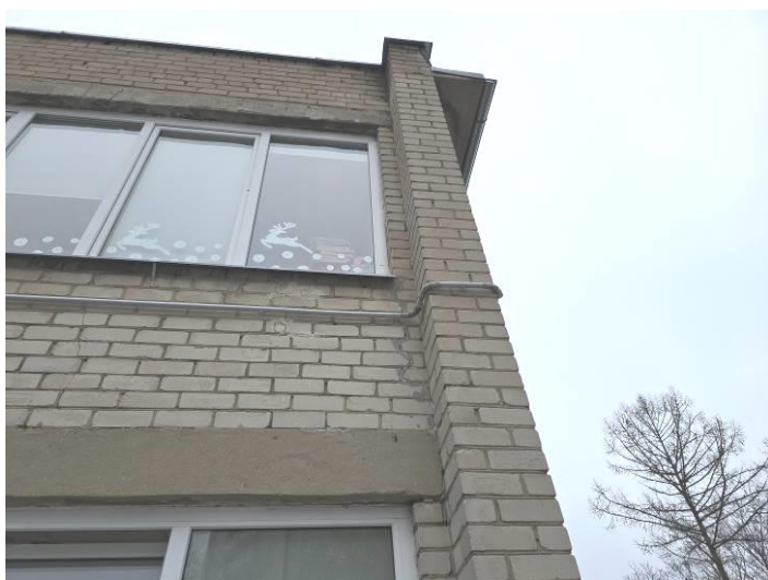
23. Plyšiai išorinėje sienoje ties patalpa 3-4.
