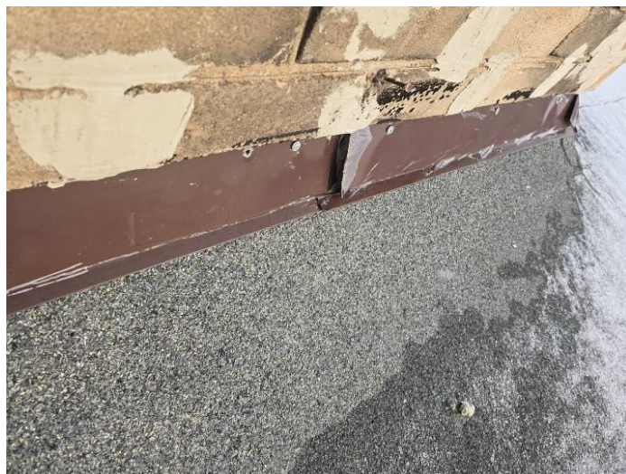
56. Netinkamai įrengtas apskardinimas ties šiaurinio korpuso ventiliacijos kaminėliu. Matoma atsilupusi skarda. Skarda neįleista į mūrą, neuždėtas joks hermetikas.
