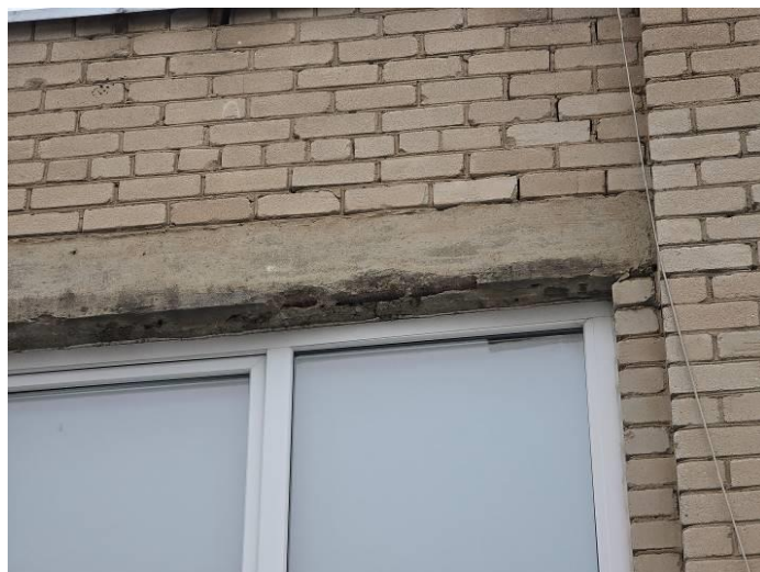
16. Atšokęs apsauginis armatūros sluoksnis sąramoje ties antro aukšto patalpa 3-5 vakarinėje pastato pusėje.
