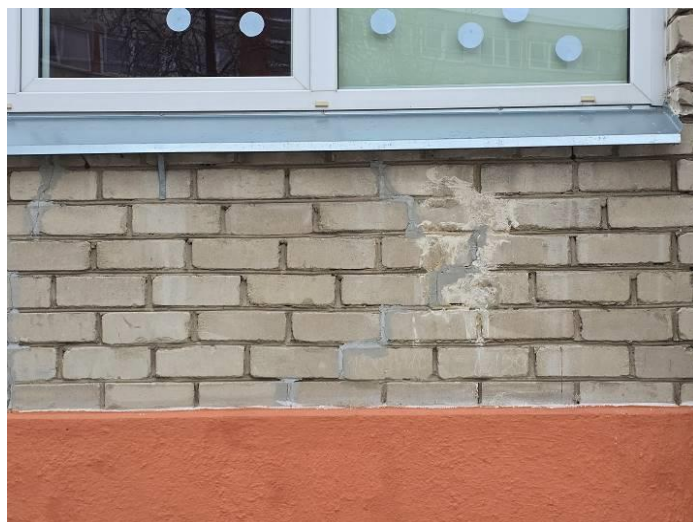
40. Plyšiai išorinėje sienoje ties patalpa 1-21 (rytinis fasadas).
