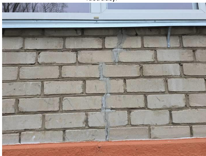
42. Plyšiai išorinėje sienoje ties patalpa 1-21 (rytinis fasadas).
