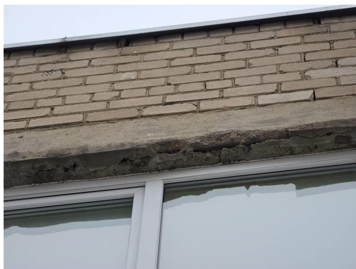
18. Atšokęs apsauginis armatūros sluoksnis sąramoje ties antro aukšto patalpa 3-5 vakarinėje pastato pusėje.
