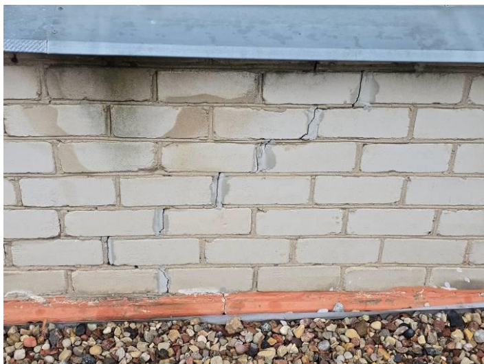
21. Plyšiai išorinėje sienoje ties patalpa 1-37.
