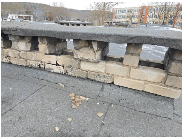
61. Erozijos veikiamas kaminėlio mūras.
