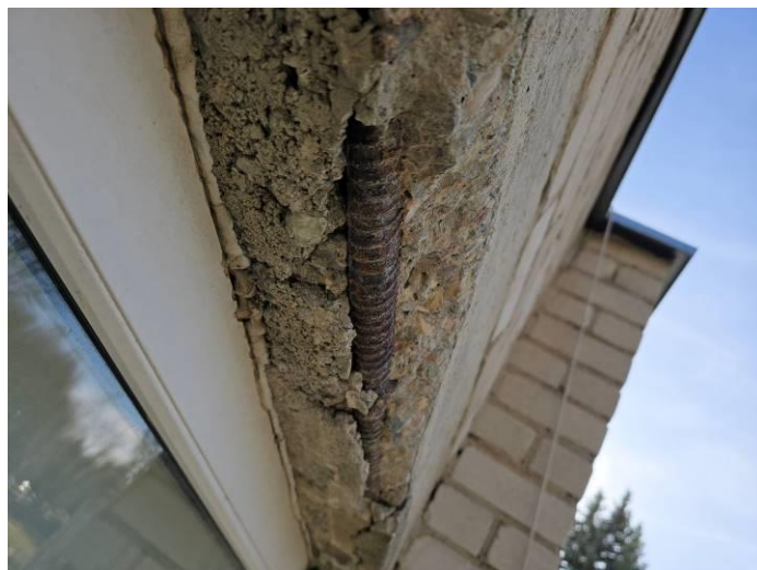
26. Atšokęs apsauginis armatūros sluoksnis sąramoje ties antro aukšto patalpa 3-5 vakarinėje pastato pusėje. Matoma korozijos veikiami armatūra.
