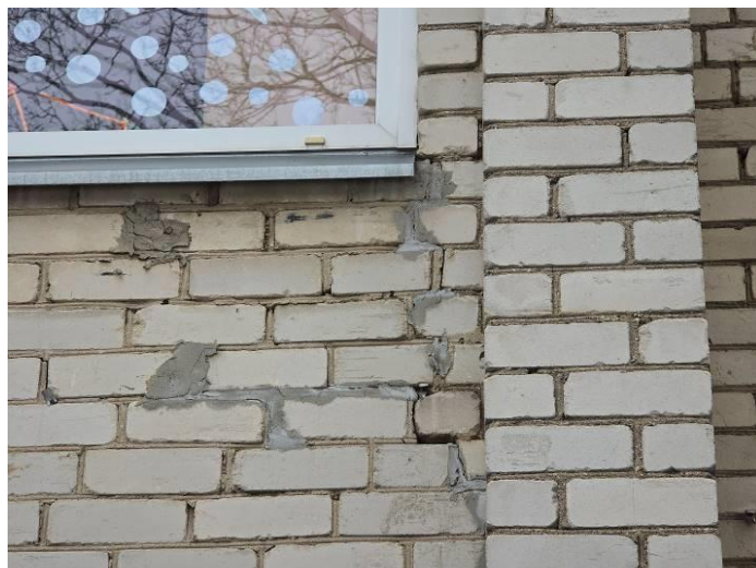
50. Plyšiai išorinėje sienoje ties patalpa 2-4 (pietinis fasadas).
