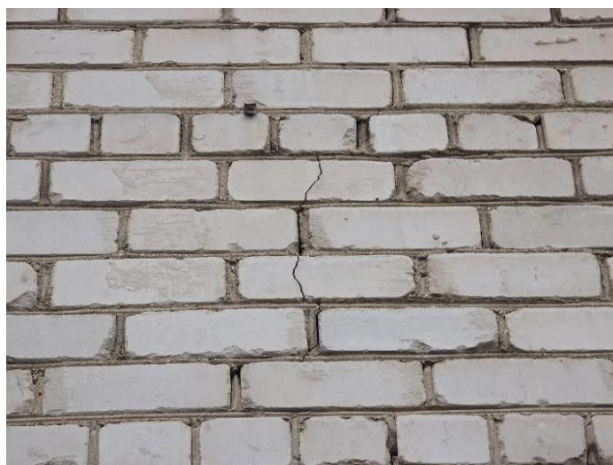
48. Plyšiai išorinėje sienoje ties patalpa pietiniame fasade.
