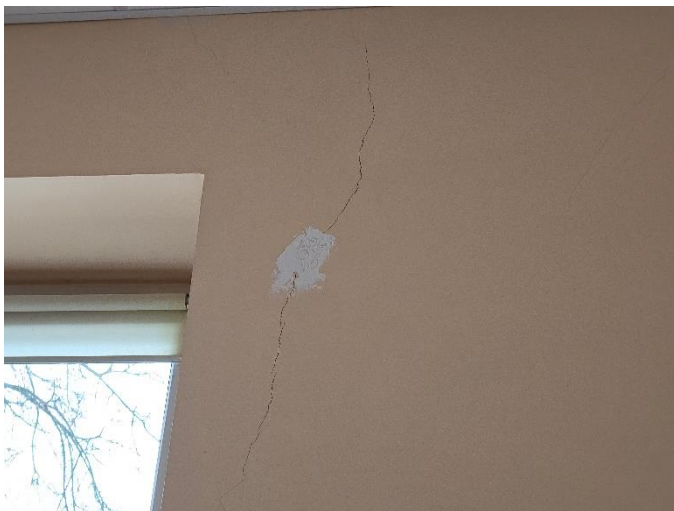
44 pav. Išorinėje sienoje matomas plyšys, uždėtos markiruotės plyšio stebėjimui sutrūkusios (antro aukšto patalpa 3-1).
