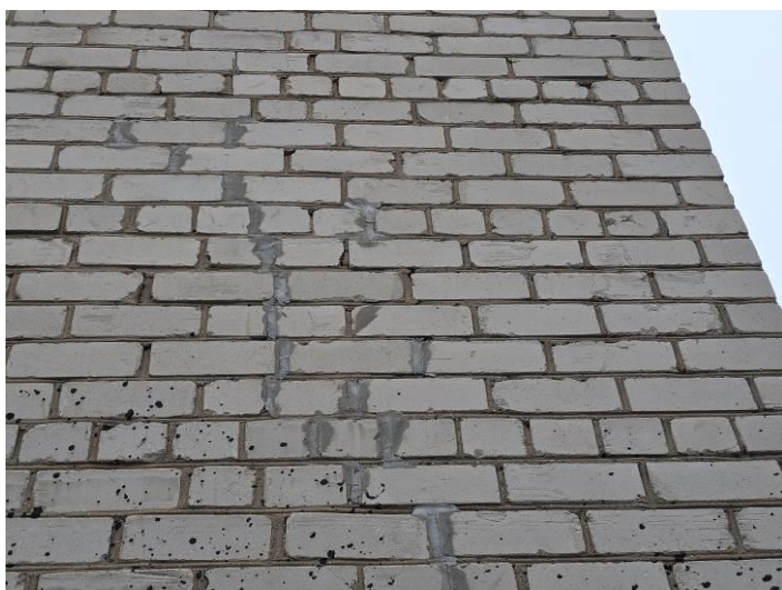
27. Plyšiai išorinėje sienoje ties patalpa 1-53.
