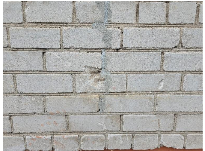
41 pav. Išorinėje mūrinėje sienoje matomas plyšys (pirmas aukštas).
