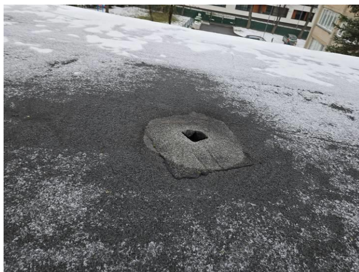
60. Nėra apsauginio dangtelio virš įlajos.
