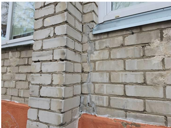
43. Plyšiai išorinėje sienoje ties patalpa 1-21 (rytinis fasadas).
