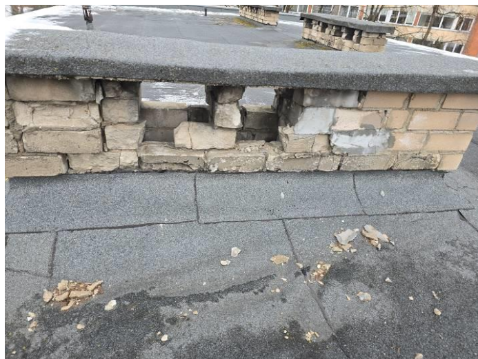
62. Erozijos veikiamas kaminėlio mūras – matomas dalinai suiręs silikatinių plytų mūras.
