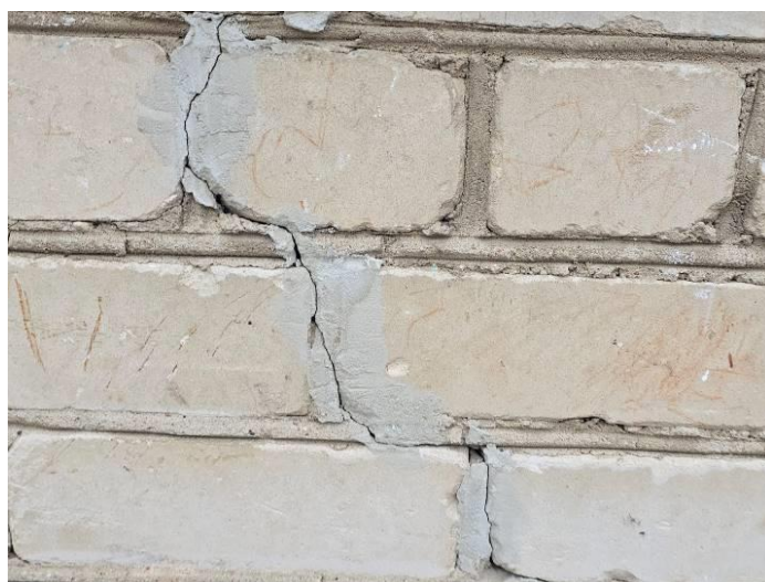
30. Plyšiai išorinėje sienoje ties patalpa 1-27 (pietinis fasadas).
