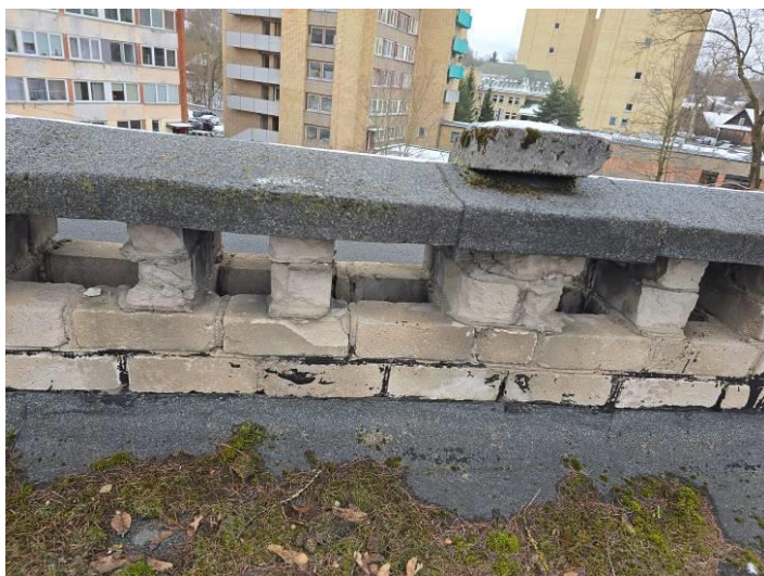
63. Erozijos veikiamas kaminėlio mūras.
