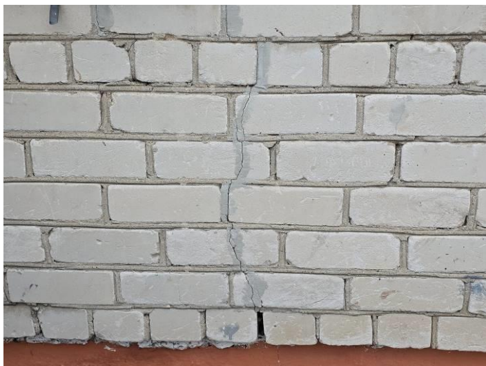
31. Plyšiai išorinėje sienoje ties patalpa 1-28 (pietinis fasadas).
