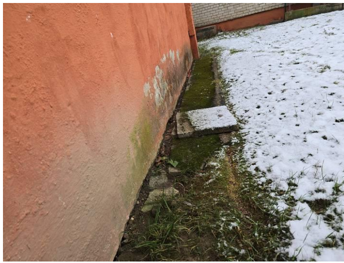
36. Bendras nuogrindos iš šaligatvio plytelių vaizdas. Nuogrinda įrengta nepilnai.
