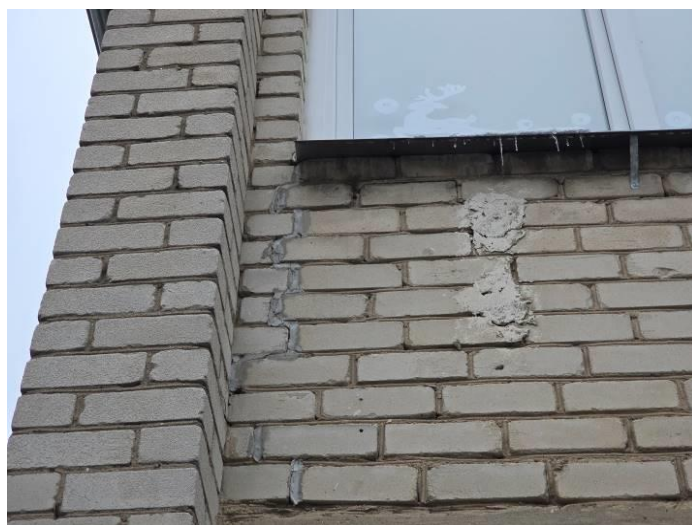
24. Plyšiai išorinėje sienoje ties patalpa 3-5.
