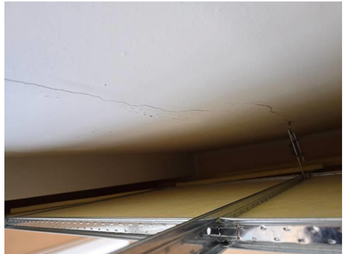
74. Ties plyšiu sienoje matomas plyšys ir tarp denginio plokščių siūlių.
