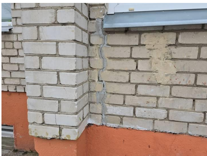
29. Plyšiai išorinėje sienoje ties patalpa 1-26 (pietinis fasadas).
