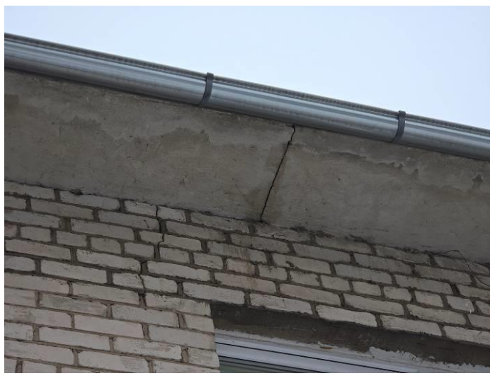
34. Bendras karnizo plokštės ties patalpa 3-2 vaizdas, matomas plyšis ties siūle tarp jų. Taip pat matomas plyšys mūre virš sąramos.
