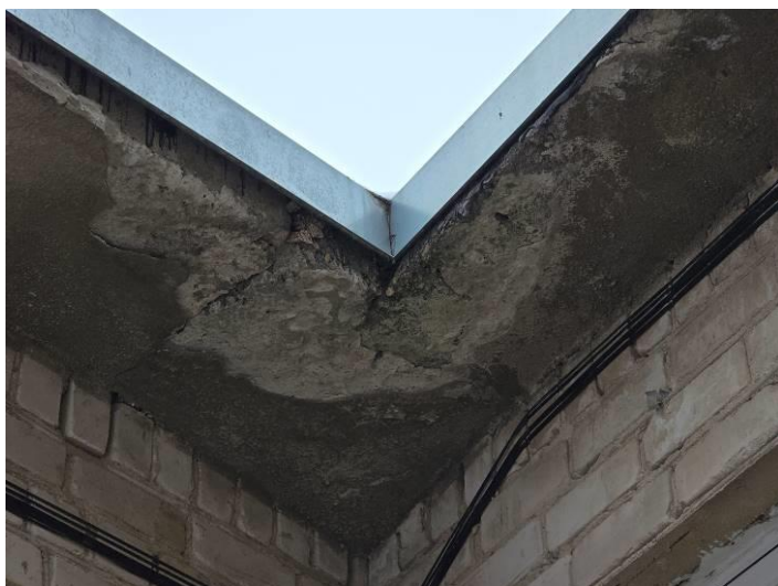
33. Dėl netinkamo apskardinimo šlampanti karnizo plokštė, matoma betono korozija.
