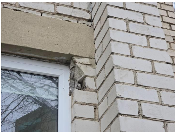
49. Atskilęs mūras ties sąramos atrama (1-4 patalpos langas).
