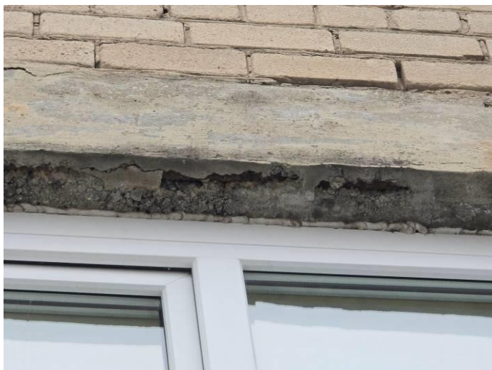
25. Atšokęs apsauginis armatūros sluoksnis sąramoje ties antro aukšto patalpa 3-5 vakarinėje pastato pusėje.
