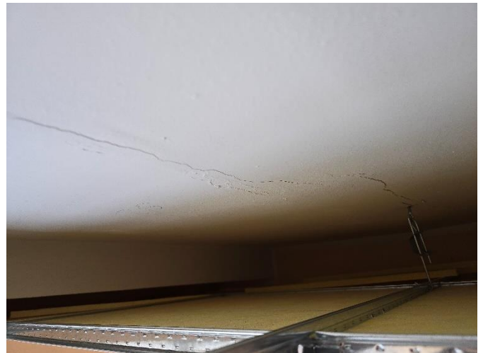
49 pav. Ties tarp denginio plokščių esančiomis siūlėmis susiformavę įtrūkimai.
