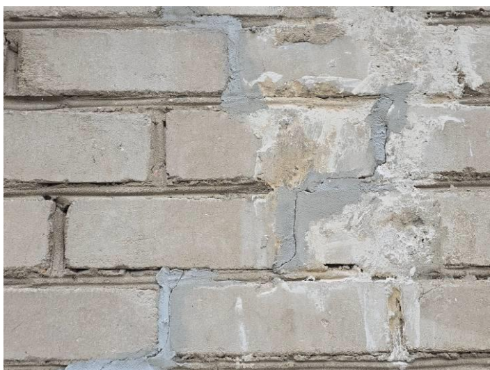
41. Plyšiai išorinėje sienoje ties patalpa 1-21 (rytinis fasadas).
