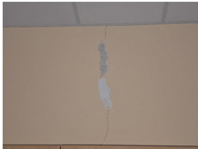
45 pav. Sienoje matomas plyšys, uždėtos markiruotės plyšio stebėjimui sutrūkusios (antro aukšto patalpa 3-1).
