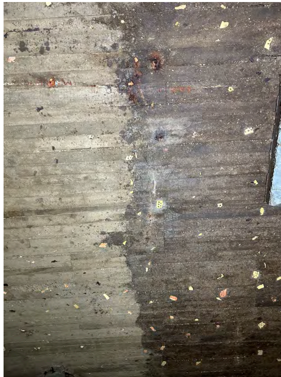
Pav. 8.3 Išorinio vandens prasiskverbimas perdangoje
