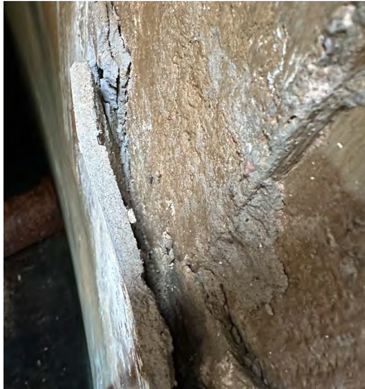
Pav. 8.5 Atrūkęs betono apsauginis sluoksnis nuo sienų
