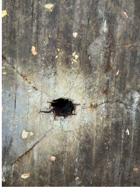
Pav. 8.2 Betone esančios armatūros korozijos požymiai trūkiuose/plyšiuose
