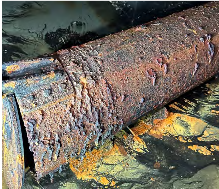
Pav. 8.9 Faktinė metalo konstrukcijų būklė
