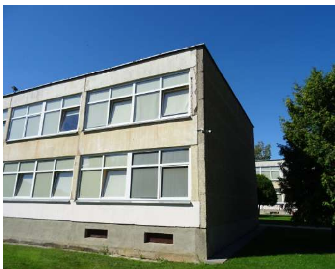
7 pav. Vietomis pastebėti sieninių plokščių apsauginio betono sluoksnio ištrupėjimai.
