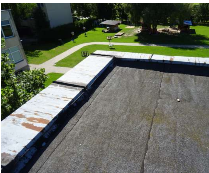
11 pav. Surūdiję parapetų apskardinimai.
