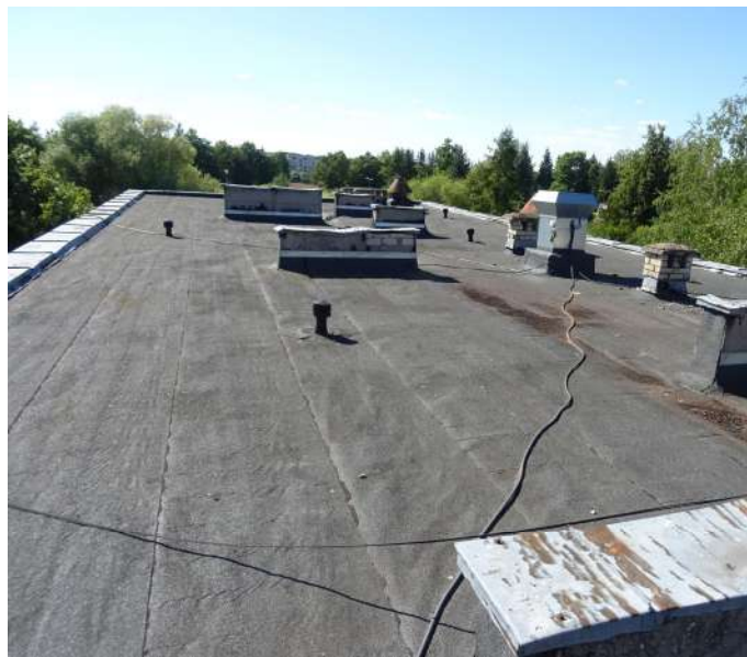
10 pav. Bendras I-ojo pastato korpuso stogo vaizdas. Stogas buvo remontuotas – uždengtas nauja bitumine ritinine stogo danga, bet papildomai neapsiltintas.
