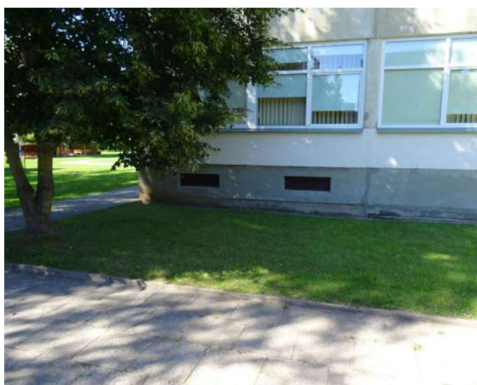
8 pav. Rūsio langai seni mediniai. Šių langų būklė ypač prasta – stiklai išdaužyti, vietoj stiklų įstatytos faneros plokštės, langų rėmai supuvę, langai nesandarūs, langus sunku arba iš viso neįmanoma varstyti.
