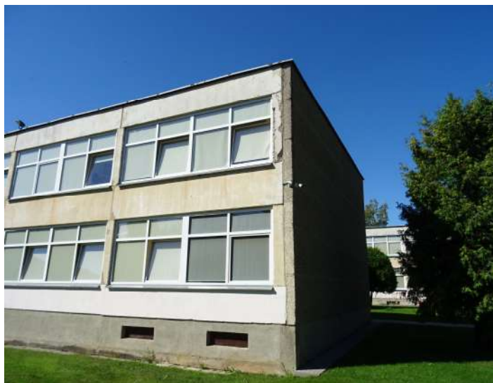
7 pav. Vietomis pastebėti sieninių plokščių apsauginio betono sluoksnio ištrupėjimai..
