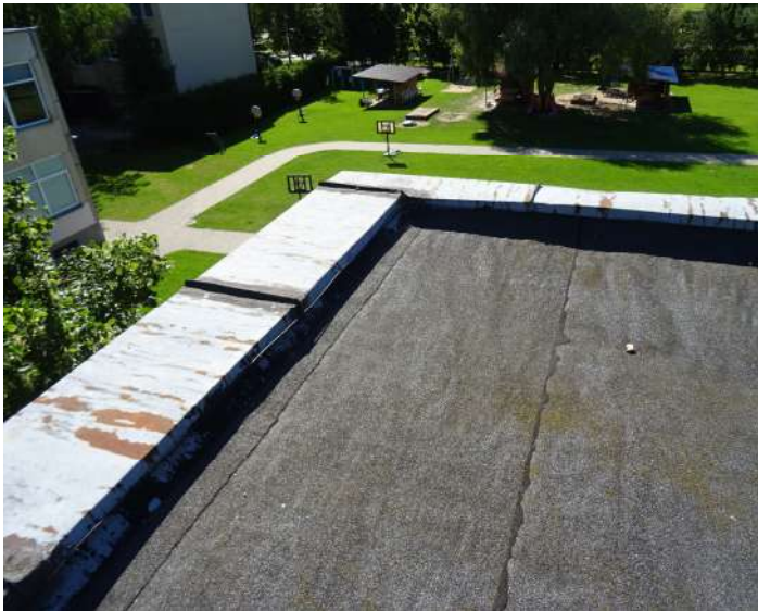
11 pav. Surūdiję parapetų apskardinimai.
