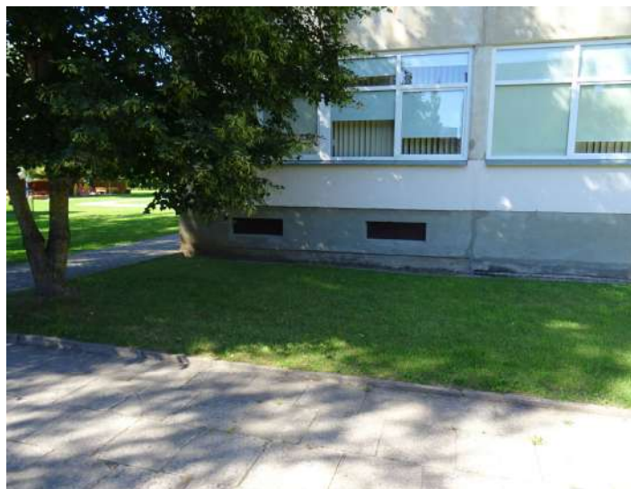
8 pav. Rūsio langai seni mediniai. Šių langų būklė ypač prasta – stiklai išdaužyti, vietoj stiklų įstatytos faneros plokštės, langų rėmai supuvę, langai nesandarūs, langus sunku arba iš viso neįmanoma varstyti.
