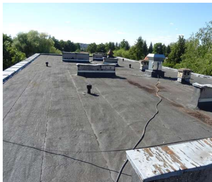
10 pav. Bendras I-ojo pastato korpuso stogo vaizdas. Stogas buvo remontuotas – uždengtas nauja bitumine ritinine stogo danga, bet papildomai neapšiltintas.
