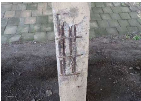
2.19 pav. Antros atramos 7 kolonos bendras vaizdas. Atšokęs ir nukritęs apsauginis betono sluoksnis, intensyviai koroduoja pagrindinės ir pagalbinės armatūrų strypai
