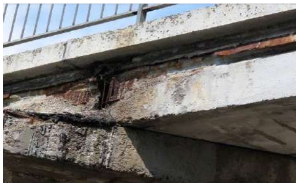
2.11 pav. Antrojo tarpatramio perdangos 1 plokštės galas virš trečios atramos. Permirkęs plokštės galas, koroduoja pagrindinės ir pagalbinės armatūros strypai
