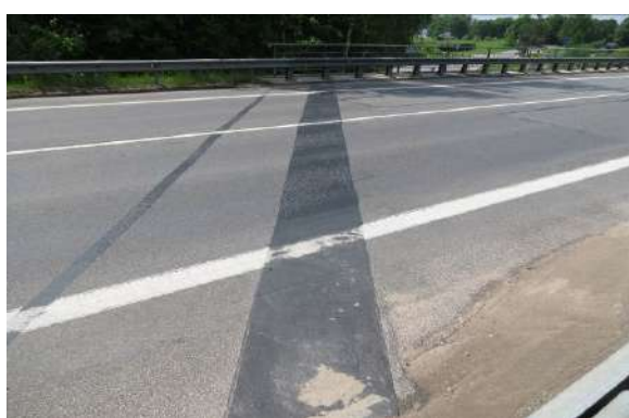
2.3 pav. Pjūvis irš 1 atramos. Pjūvis kiauuras, mastika atšokusi nuo dangos kraštų
