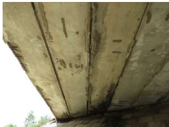
2.5 pav. Trečiojo tarpatramio perdangos bendras vaizdas. Kiaura hidroizoliacija. Per tarpus tarp plokščių sunkiasi vanduo ir karbonatiniai produktai. Kraštinėse plokštėse matyti išsisunkusio vandens dėmės
