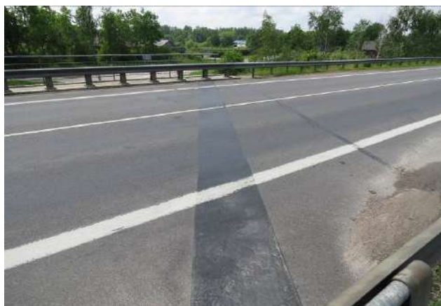
2.2 pav. Deformacinis pjūvis virš 4 atramos. Pjūvis kiauuras, mastika atšokusi nuo dangos kraštų
