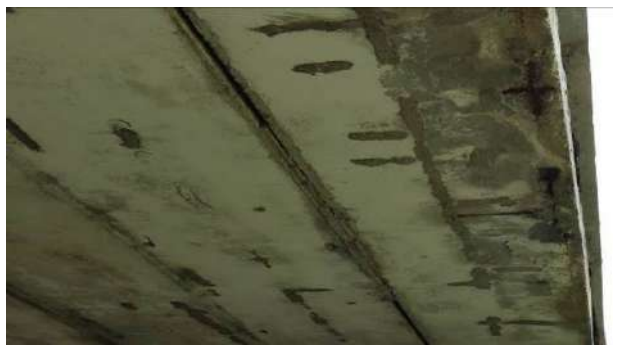
2.16 pav. Trečiojo tarpatramio perdangos 12 ir 13 plokščių bendri vaizdai. Plokštės peršlapusios, tempiamoje betono zonoje atsivėrę išilginiai plyšiai, koroduoja pagrindinė ir pagalbinė armatūra
