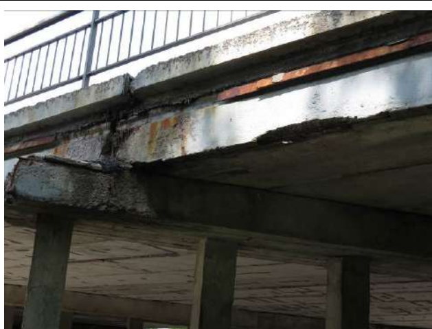
2.8 pav. Pirmojo tarpatramio perdangos 1 plokštės bendras vaizdas. Atšokęs ir nukritęs apsauginis betonas. Permirkęs plokštės galas virš antros atramos, koroduoja pagrindinė ir pagalbinė armatūra
