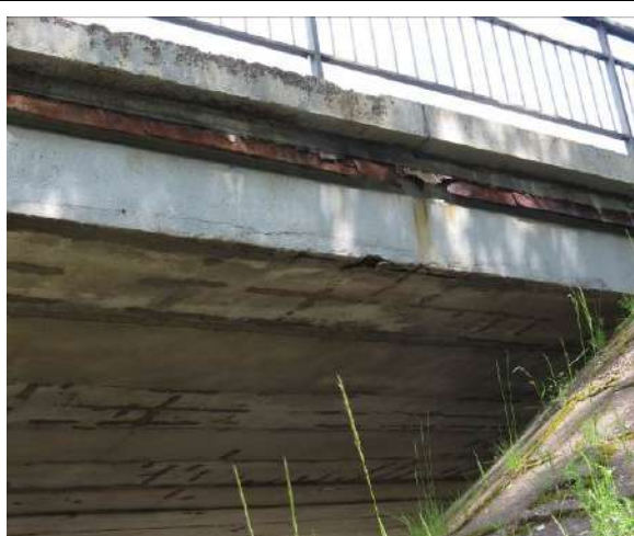
2.7 pav. Pirmojo tarpatramio perdangos 1 plokštės bendras vaizdas. Tempiamoje betono zonoje atsivėrę išilginiai plyšiai, koroduoja pagrindinė ir pagalbinė armatūros
