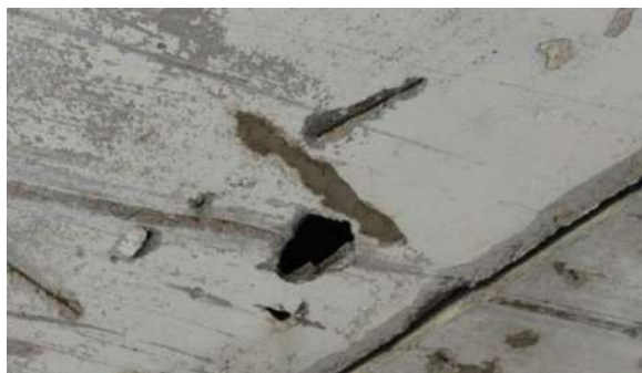
2.13 pav. Antrojo tarpatramio perdangos 11 plokštės bendras vaizdas. Plokštė pažeista mechaniškai, jos apačioje yra kiaurymė pro kurią matyti, kad koroduoja įtempta armatūra
