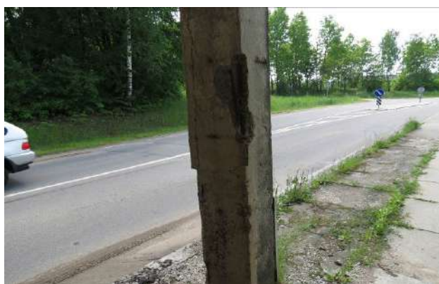
2.22 pav. Trečios atramos 1 kolonos bendras vaizdas. Kolonoje atsivėrę išilginiai 1,2 – 2,6 mm pločio plyšiai. Vietomis nutrupėjęs apsauginis betono sluoksnis, koroduoja į paviršių išlindę armatūros strypai
