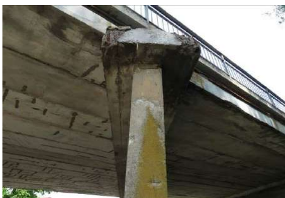
2.21 pav. Antros atramos rygelio galas kairėje pusėje. Rygelio galas peršlapęs, nutrupėjęs apsauginis betono sluoksnis, koroduoja į paviršių išlindę armatūros strypai
