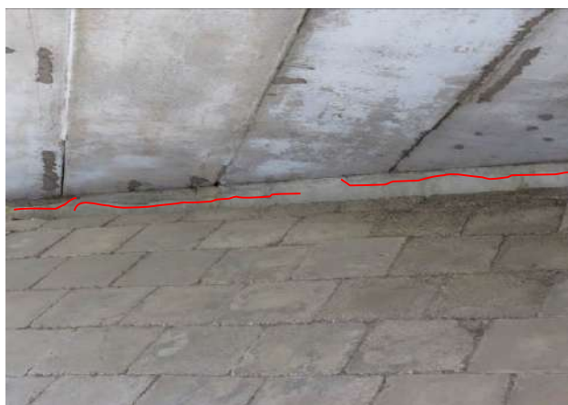
2.26 pav. Peršlapęs ir supleišėjęs ketvirtos atramos rygelis. Rygelio viršuje atsivėrę išilginiai plyšiai
