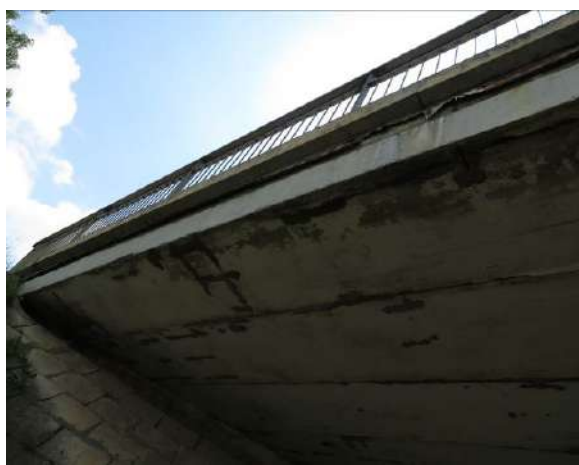
2.9 pav. Pirmojo tarpatramio perdangos 13 plokštės bendras vaizdas. Tempiamoje betono zonoje atsivėrę išilginiai plyšiai, koroduoja pagrindinė ir pagalbinė armatūra
