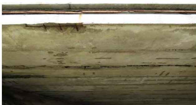
2.14 pav. Trečiojo tarpatramio perdangos 1 plokštės bendras vaizdas. Plokštė peršlapusi, tempiamoje betono zonoje atsivėrę išilginiai plyšiai, vietomis atsokęs ir nukritęs apsauginis betono sluoksnis, koroduoja į paviršių išlindusi armatūra
