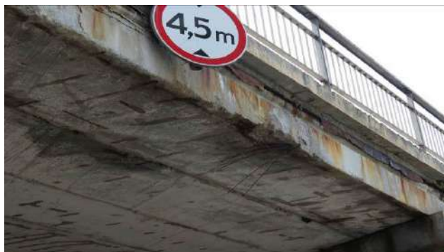
2.12 pav. Antrojo tarpatramio perdangos 13 plokštės bendras vaizdas. Plokštė pažeista mechaniškai, dalis įtemptų vielapluoščių yra nutraukti, todėl sumažėjusi plokštės laikomoji geba
