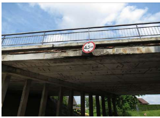
2.10 pav. Antrojo tarpatramio perdangos 1 plokštės bendras vaizdas. Plokštė pažeista mechaniškai, jos tempiamoje betono zonoje atsivėrę išilginiai plyšiai, koroduoja pagrindinė ir pagalbinė armatūra
