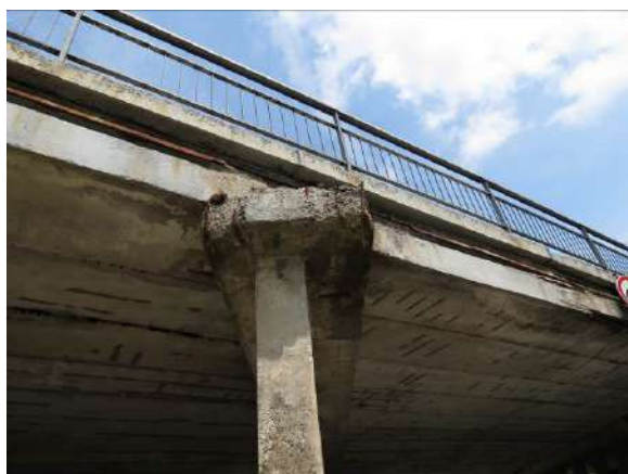
2.25 pav. Peršlapęs ir aptrupėjęs trečios atramos rygelio galas kairėje pusėje. Rygelio gale atšokęs apsauginis betono sluoksnis, koroduoja į paviršių išlindę armatūros strypai
