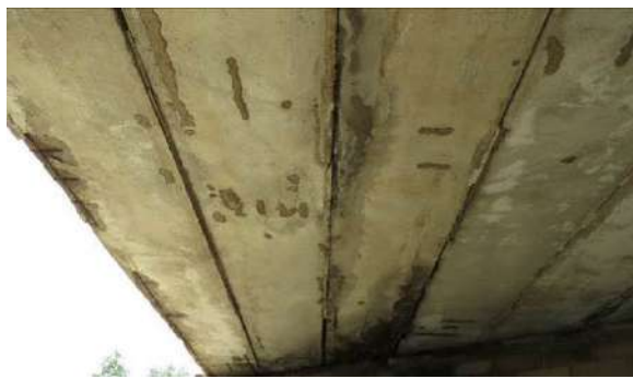
2.15 pav. Trečiojo tarpatramio perdangos 1, 2 ir 3 plokščių bendri vaizdai. Plokštės peršlapusios, tempiamoje betono zonoje atsivėrę išilginiai plyšiai, koroduoja pagrindinė ir pagalbinė armatūra
