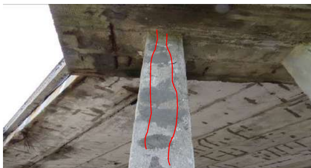
2.24 pav. Išilginiais plyšiais supleišėjusi trečios atramos 12 kolona
