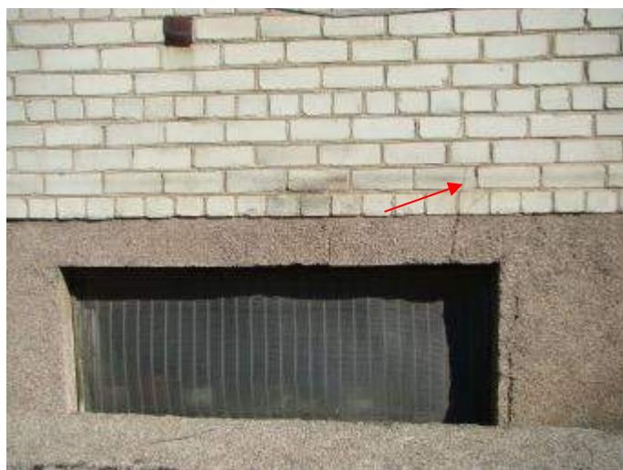
8. Įtrūkimas mūro sienoje iki gelžbetoninės sąramos
