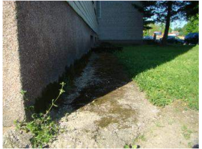
12. Nusėdusi, supleišėjusi, erozijos pažeista, be nuolydžio nuo pastato nuogrinda
