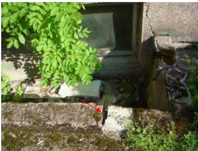
15. Grunto išstumta prieduobės siena; prieduobė neprižiūrėta, neišvalyta ir dėl to kaupianti drėgmę prie pastato sienos
