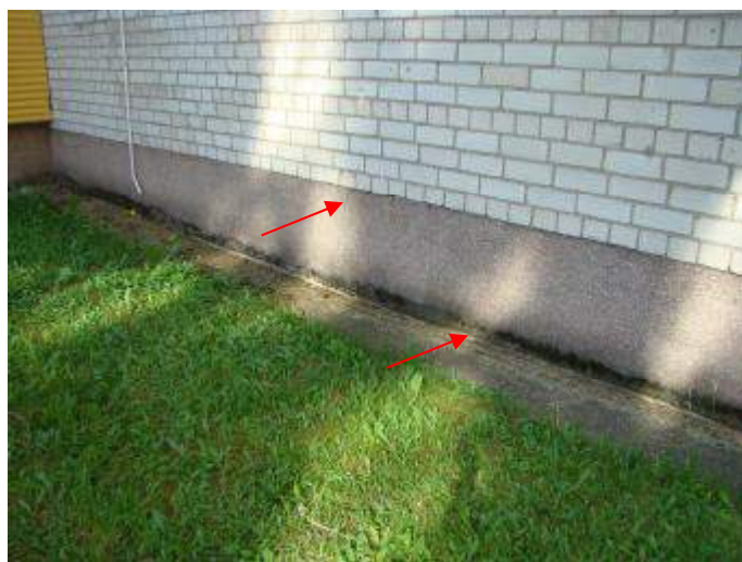
6. Įtrūkimas sienos cokolinėje dalyje; nusėdusi nuogrinda
