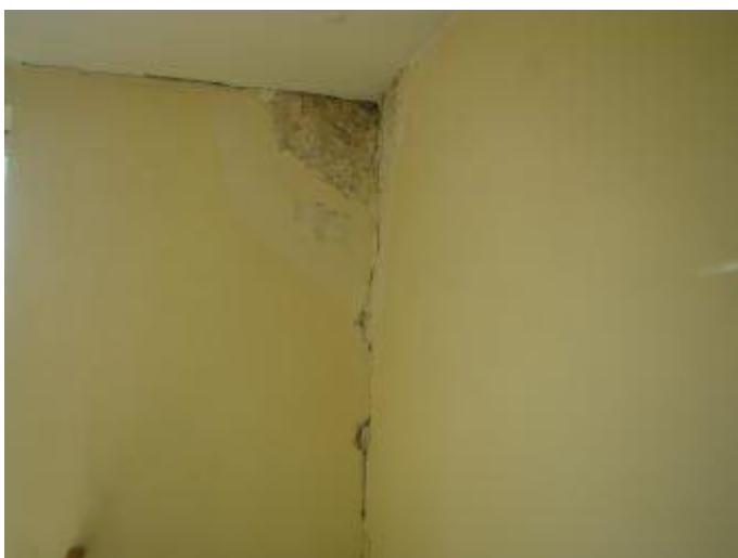
19. Drėgmės dėmė ties denginiu – sienos peršalimo požymis; įtrūkimas tarp statmenų laiptinės sienų ašyse 6-D*
