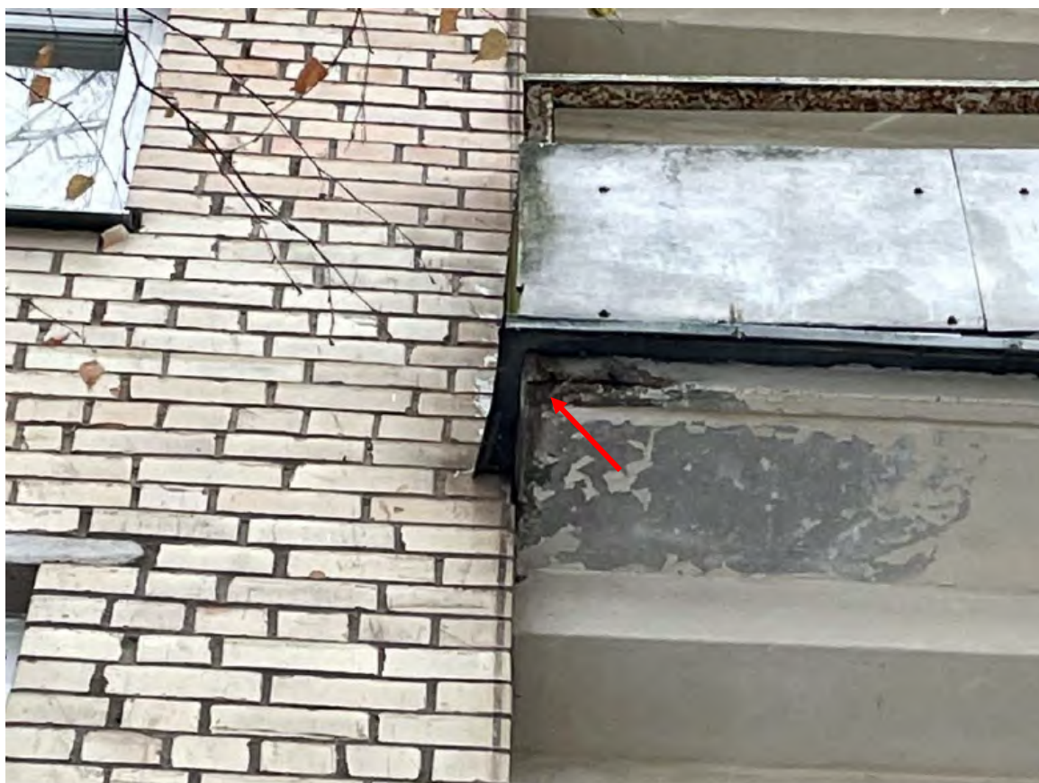
10 pav. Korozijos pažeista balkono plokštė
