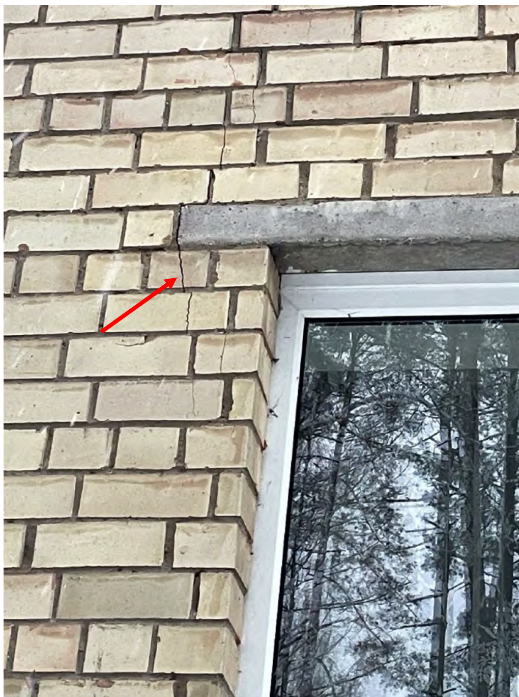
5 pav. Plyšys mūre ties sąramos atrama
