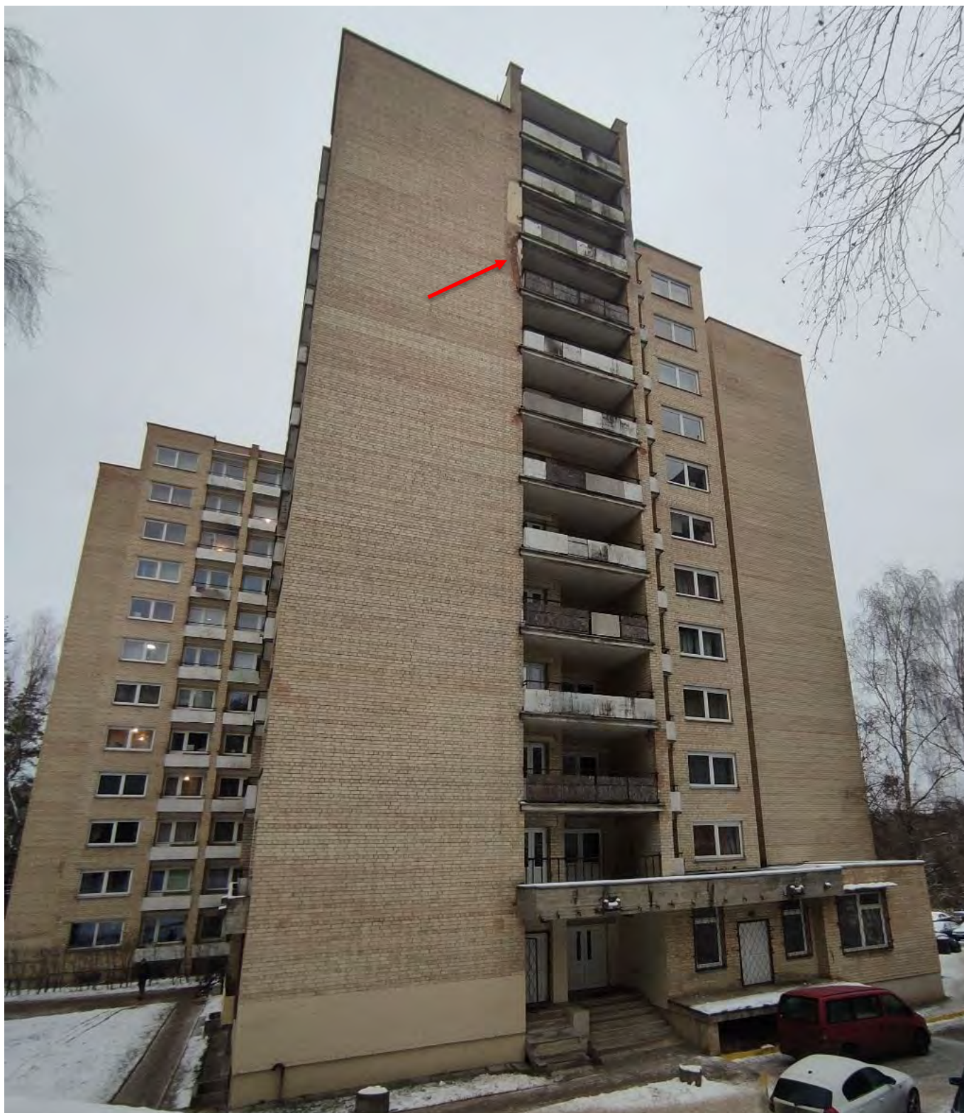
3 pav. Šiaurės-vakarų fasadas (erozijos pažeistas mūras)
