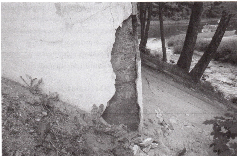
3.4 pav. Nuo kairiojo ramto aukštutinės pusės nukritęs tinkas (tamsi dėmė), viršuje tinkas suskeldėjęs, dešinėje – atšokęs nuo ramto fasadinės sienelės apie 5 mm. 2019.06.20
