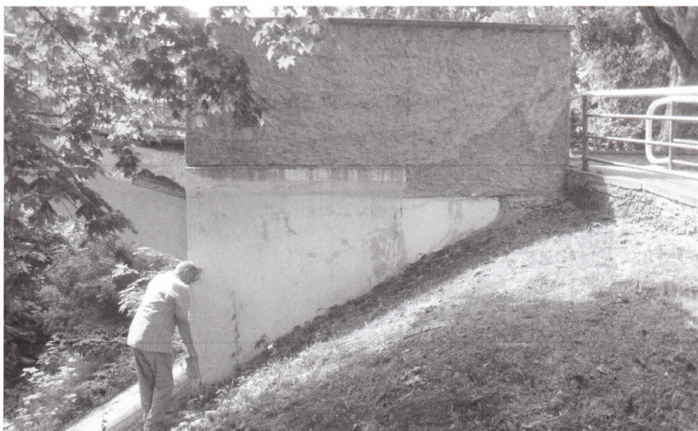
3.3 pav. Kairiojo ramto žemupinė pusė: vertikalus plyšys ties karnizo iš baltų plytų galu
