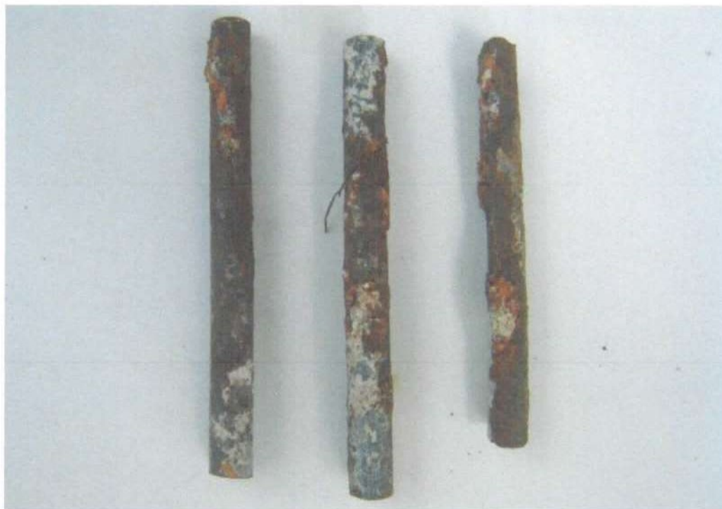
6 pav. Sukorodavusi armatūra paimta iš perdengimo plokštės
