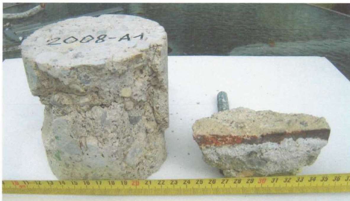
9 pav. Kairėje: suardytas perdangos bandinys. Dešinėje: sukorodavusios armatūros pėdsakas
