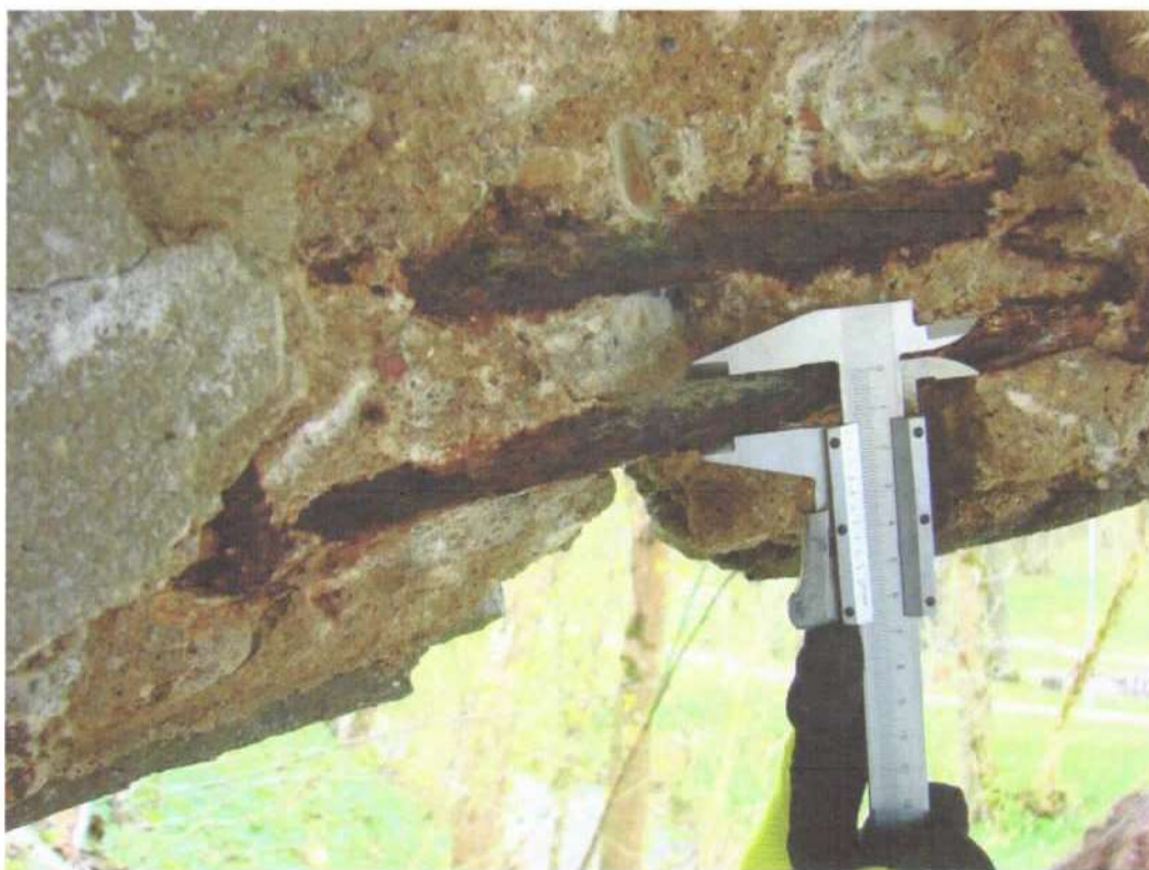
5 pav. Dėl koroduojančios armatūros perdangos briaunos (sijos) supleišėjo beveik visame jų ilgyje: a – žemupinė sija, b – sukorodavusi sijos armatūra Foto 2016 m
