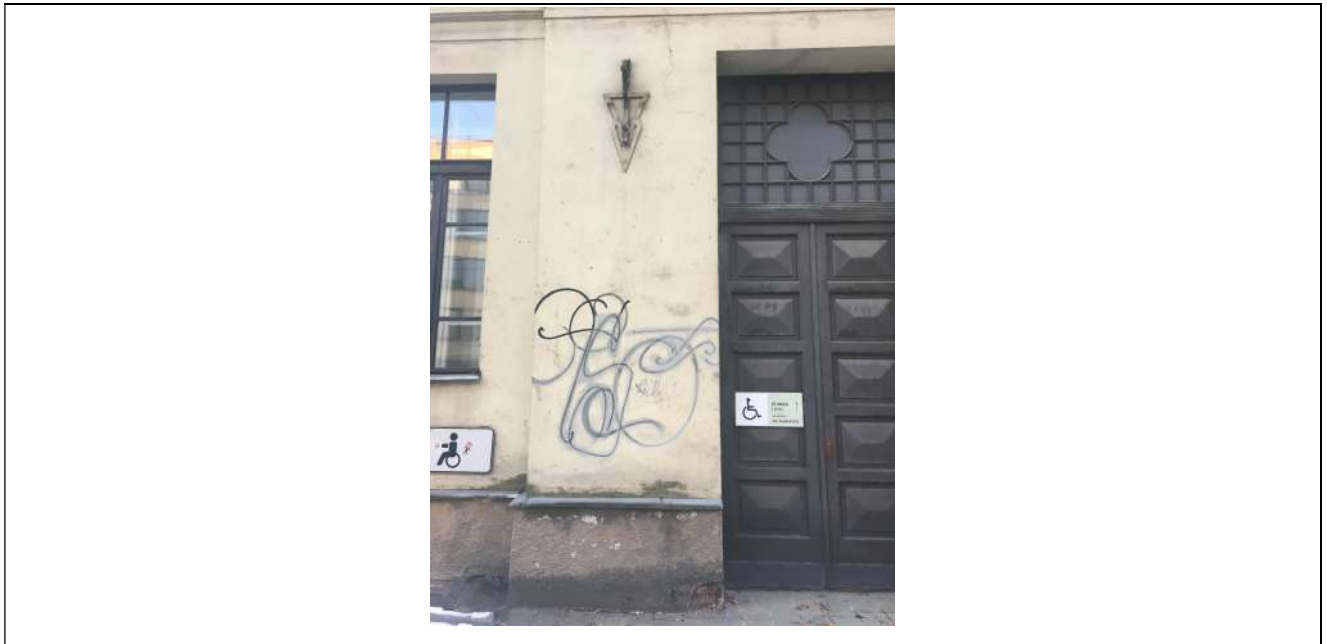
2 pav. fasado apdailos esamos būklės foto fikscija
