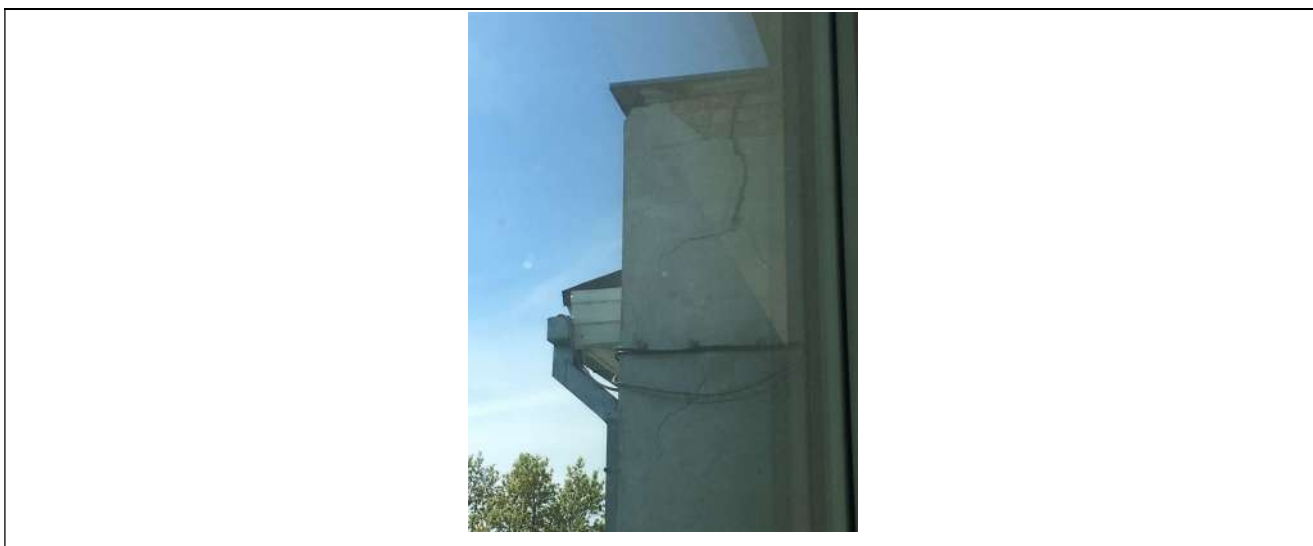
4 pav. parapeto esamos būklės foto fikscija
