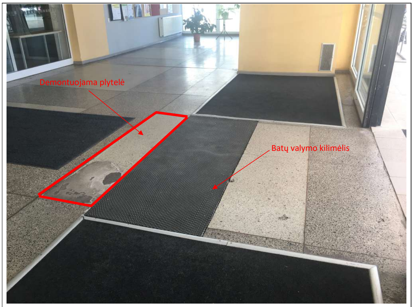
1 pav. grindų dangos esamos būklės foto fikscija
