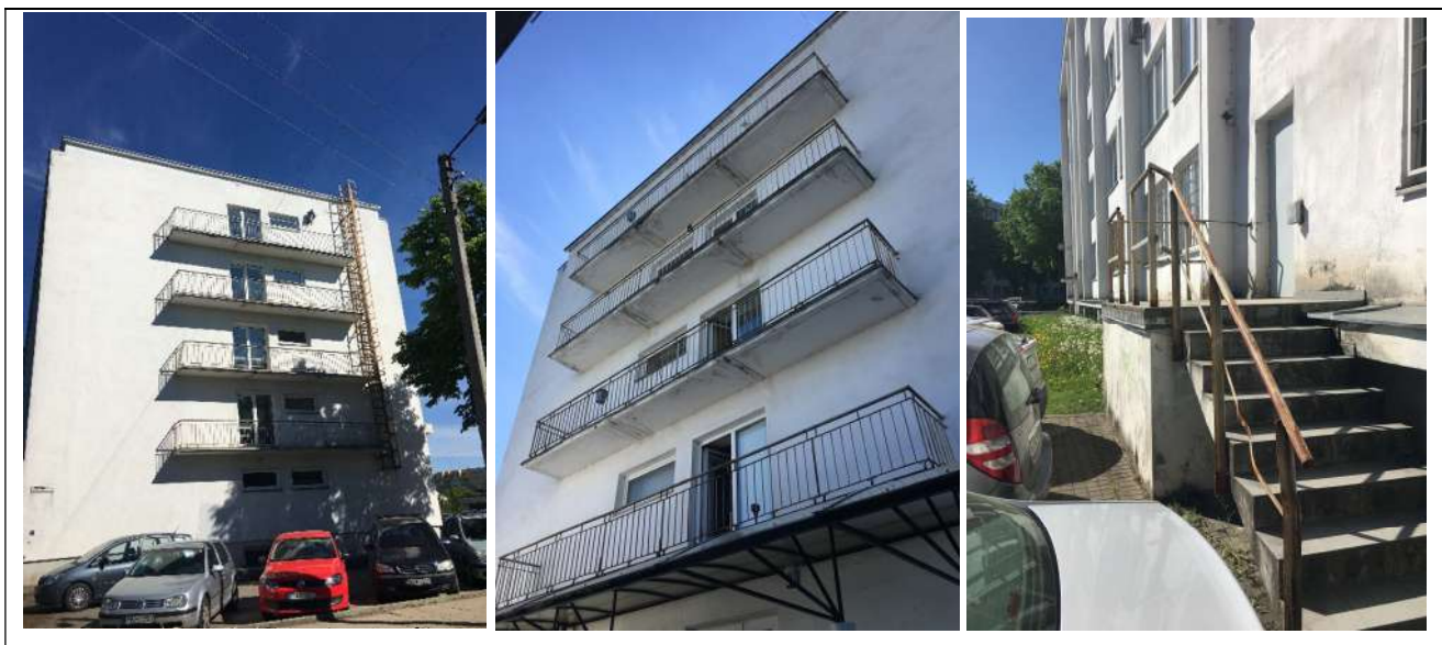
1 pav. Metalinių elementų esamos būklės foto fikсacija
