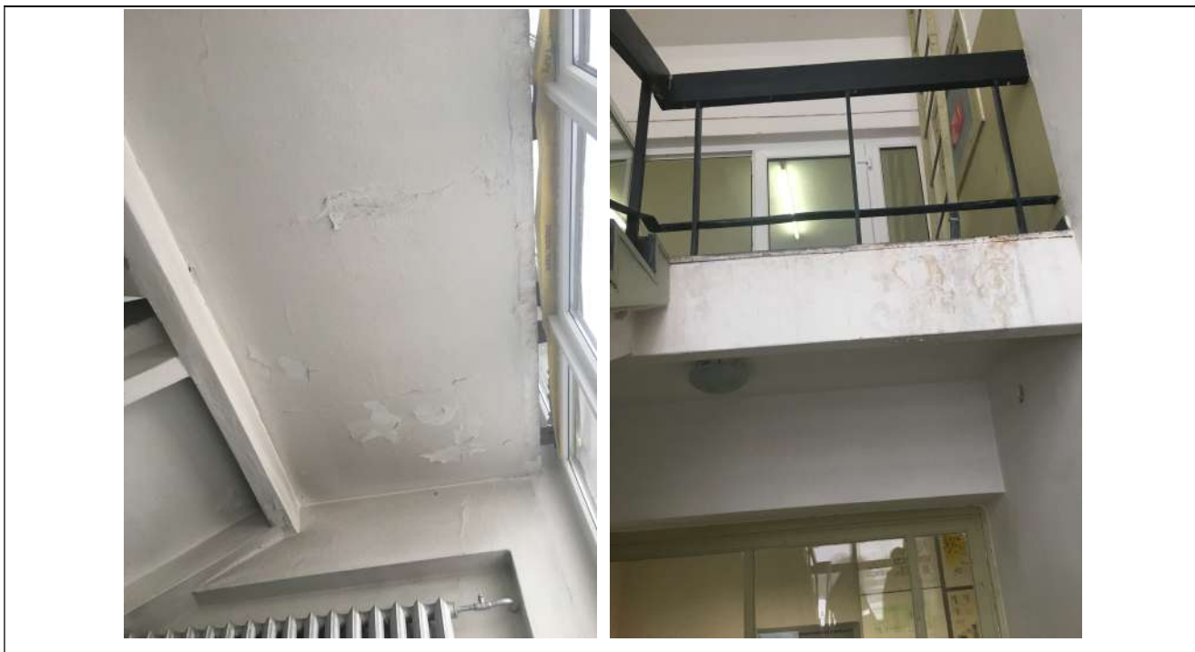
1 pav. laiptinės lubų esamos būklės foto fiksacija
