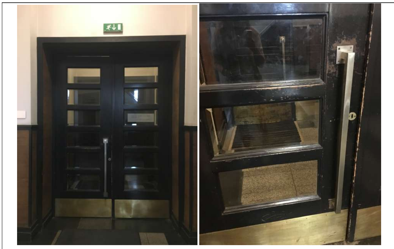
2 pav. pagrindinio įėjimo tabūro durų esamos būklės fotografacijos
