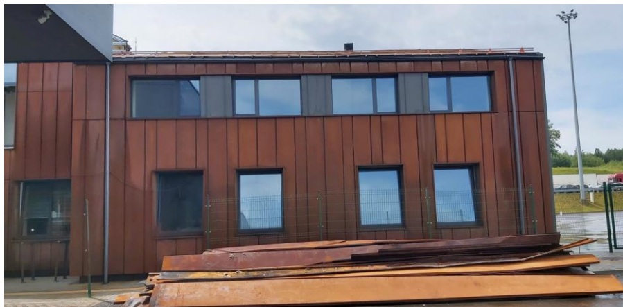
71 pav. Pastato šiaurės fasado vakarinės dalies bendrasis vaizdas – fotonuotraukoje matoma šiaurės fasado sienos vakarinė atkarpa tarp ašių „1“–„2“ liko nepažeista, tačiau pažeistas visas stogas
