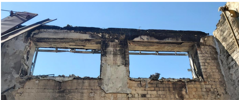
6 pav. Pastato apdegusios mūro sienos su buvusiais langais vaizdas, 2024 m. gegužės 2 d.
