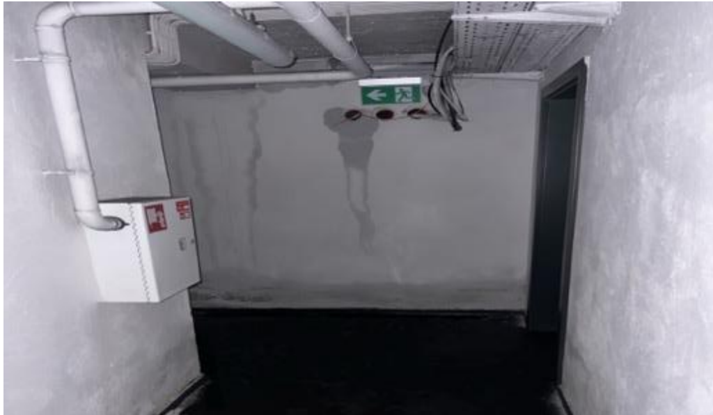
52 pav. Užpiltos rūšio patalpos – drėgmė ant perdangos, sienų, grindų
