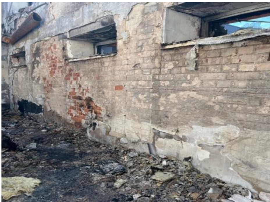
33 pav. Lauko mūrinės sienos apatinės pusės vaizdas patalpoje – išsisluoksniavo ir dalinai nutrupėjo plytų paviršius, pažeistas mūro skiedinio paviršius
