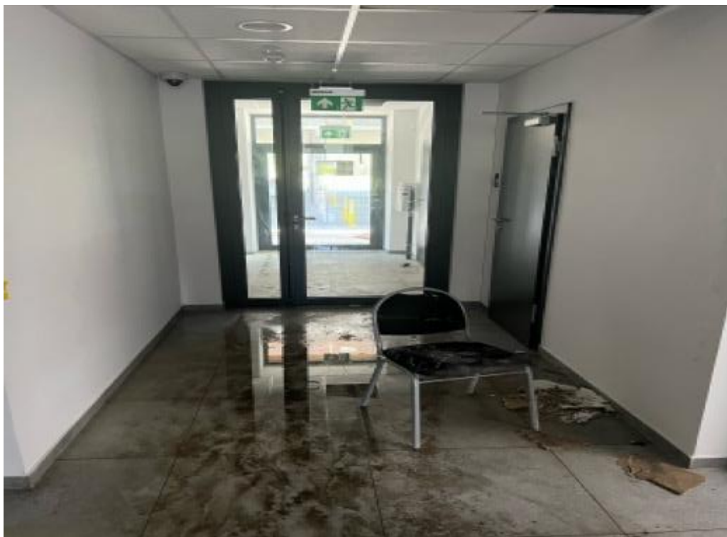
53 pav. Užpiltos pirmojo aukšto patalpos – drėgmė perdangoje, ant sienų, ant grindų
