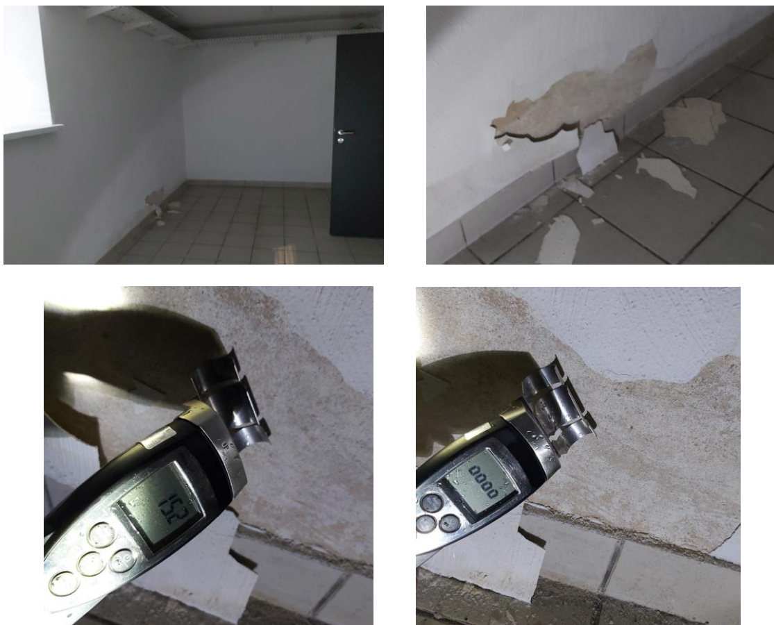
78 pav. Pastato nepažeistosios dalies tarp ašių „4“–„6“ ir „A“–„F“ rūšio išorės sienos yra šlapios, drėgmės lygio matavimo rezultatai: 15,2 % ir virš 20 %
