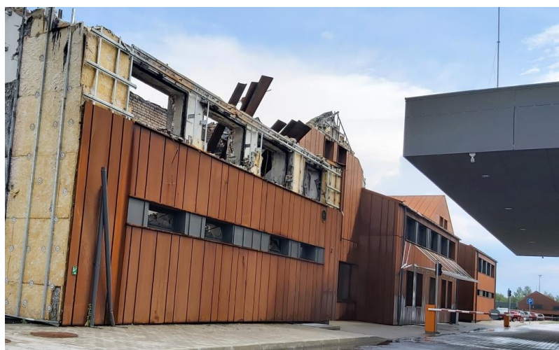
73 pav. Pastato pietų fasado bendrasis vaizdas – fotonuotraukoje matome, kad: tarp ašių „1“–„3“ vakarinė fasado dalis pažeista ir stogo dalis pažeista; tarp ašių „3“–„4“ vidurinė fasado dalis nepažeista, o stogas – dalinai pažeistas
