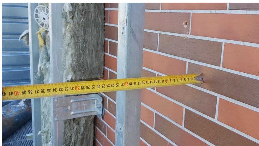
65 pav. Atstumo tarp sienos ir apšiltinimą laikančio metalinio karkaso matavimas: ant sienos išliko 150 mm storio apšiltinimo akmenų vatos sluoksnis ir 200 mm atstumu prikabinas metalinis karkasas
