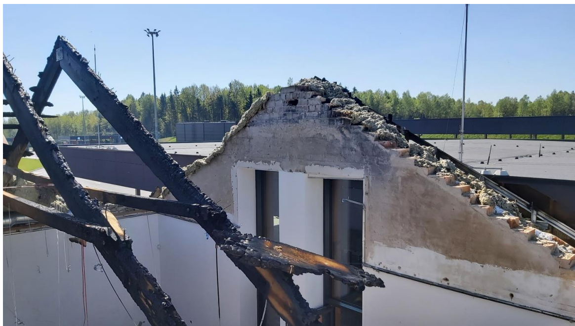
42 pav. Stogo fragmento tarp ašių nuo „2“ iki „3“ ir nuo „D“ iki „E“ medinės gegnės yra apdegę nuo 50 iki 100 %, pilnai 100 % pažeista stogo danga
