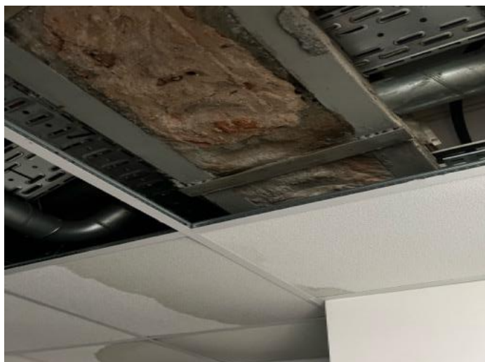
99 pav. Pirmojo aukšto patalpos pakabinamųjų lubų ir atidengtų inžinerinių sistemų vaizdas: drėgnos pakabinamų lubų apdailinės plokštės, ant kitų paviršių susikaupė drėgmė
