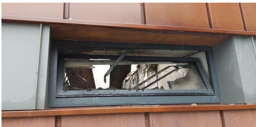
51 pav. Lauko fasado ašyje „F“ apdegę langai, išdaužyti stiklai, iškraipyti langų rėmai
