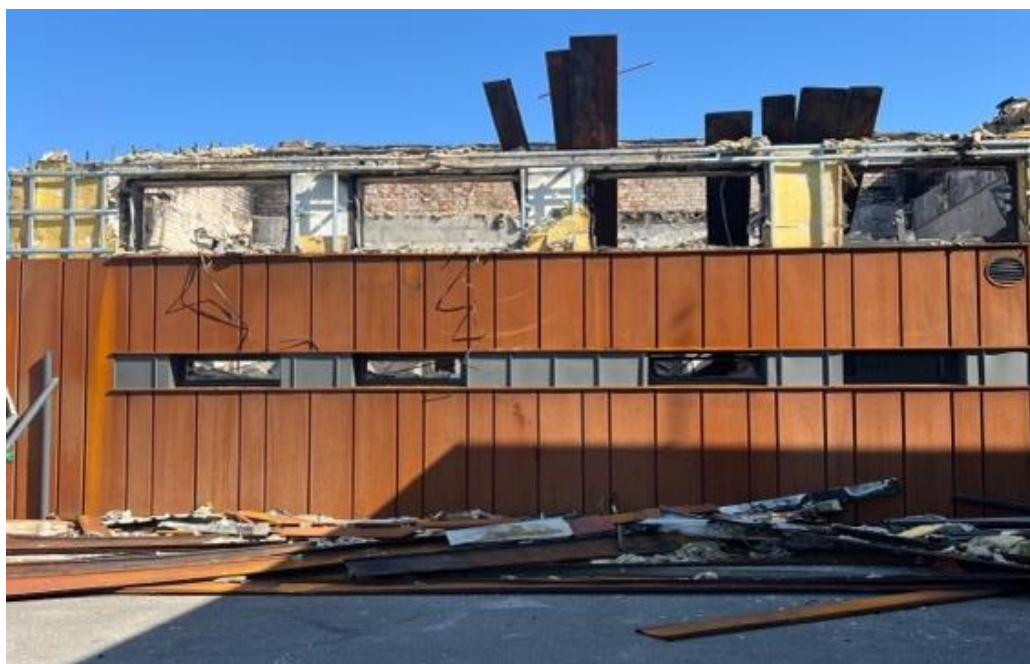
29 pav. Išdegusios stogo laikančiosios konstrukcijos, pažeistas pietinis fasadas, sugadinti langai, dalis stogo konstrukcijų nukrito
