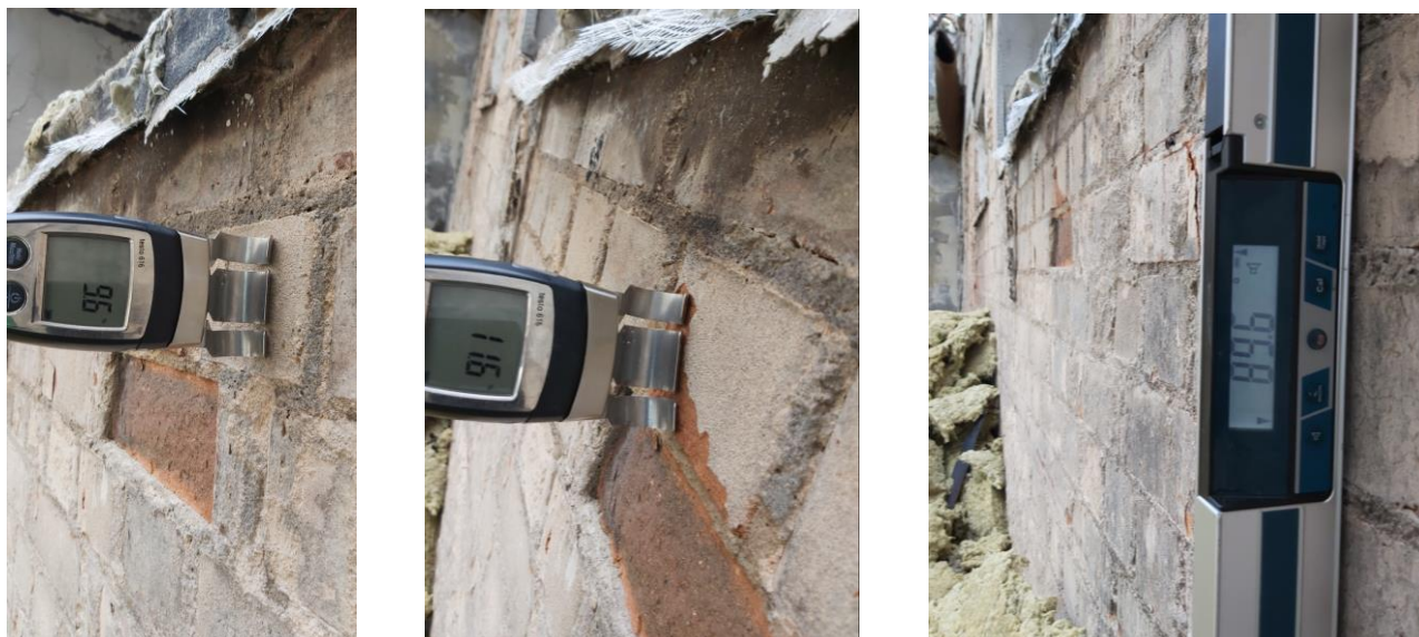
79 pav. Pastato gaisro pažeistos patalpos tarp statinio ašių „1“–„2“ ir „D“–„F“ plytų mūro sienos yra šlapios, drėgmės lygio matavimo rezultatai: 9,6 ir 11,6 %. Patikrintas sienos vertikalumas – 89,6 laipsnio mažai nukrypsta nuo 90 laipsnių
