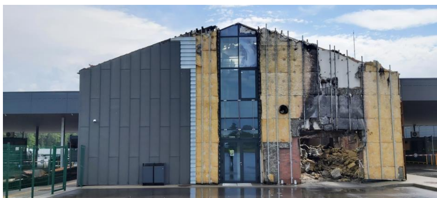
72 pav. Pastato vakarų fasado bendrasis vaizdas – fotonuotraukoje matome, kad tiek sienos, tiek stogas yra pažeisti
