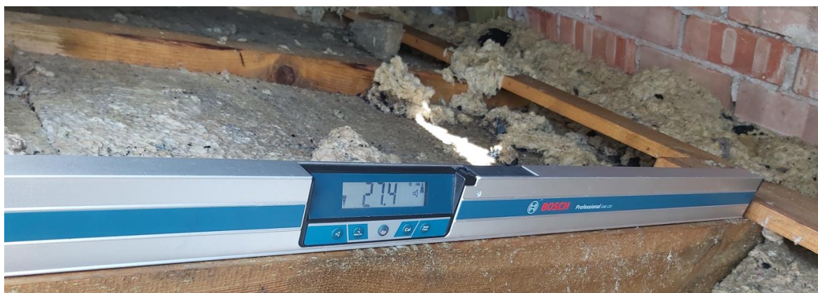
56 pav. Stogo gegnių nuolydžio tikrinimas tarp ašių „2“–„3“ ir „C“–„D“: 27,4 laipsnių (projekte nurodytas 33 laipsnių nuolydis)
