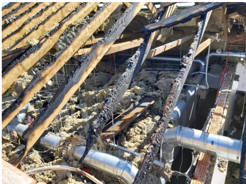
90 pav. Pastato fragmento sudegusiųjų stogo laikančiųjų medinių gegnių ir kitų konstrukcijų, sudegusios stogo dangos bendrasis vaizdas
