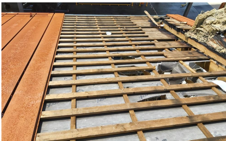
41 pav. Dalinai pažeisto stogo konstrukcijų už ašies „3“ bendrasis vaizdas
