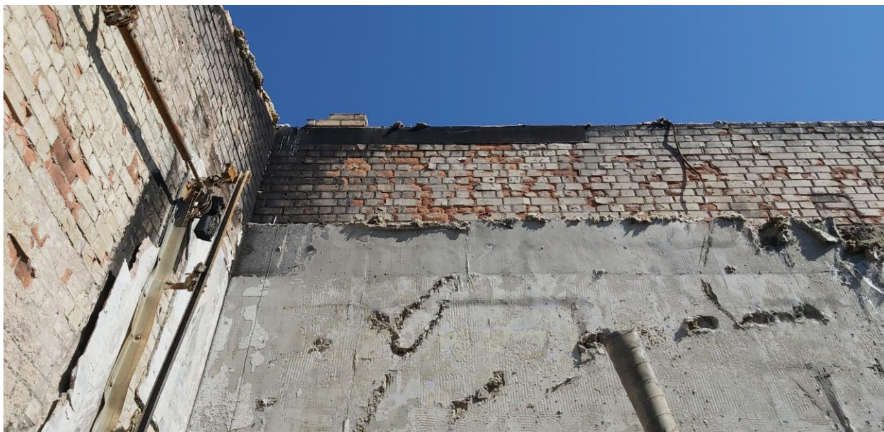
34 pav. Vidinės mūro sienos viršutinio krašto vaizdas, žiūrint iš gaisro židinio patalpos – išsisluoksniavo ir dalinai nutrupėjo plytų paviršius, pažeistas mūro skiedinio paviršius
