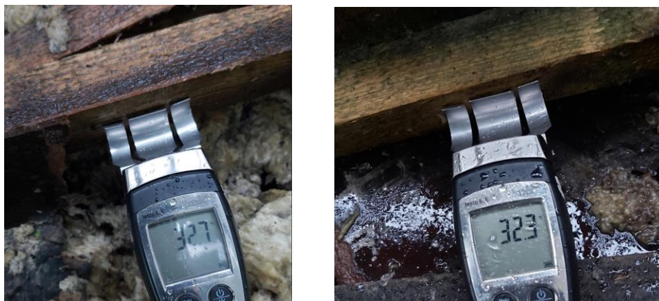
77 pav. Pastato pažeistosios dalies tarp ašių „1“–„3“ ir „A“–„F“ stogo konstrukcijos yra šlapios, drėgmės lygio matavimas: 32,7 ir 32,3 %
