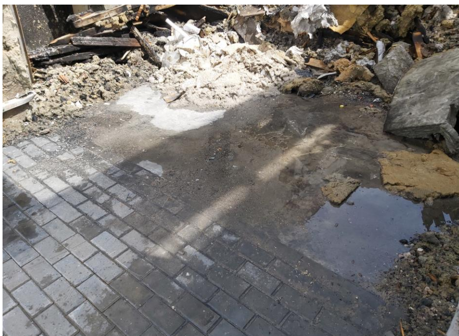
80 pav. Gaisro židinio patalpos tarp statinio ašių „1“–„2“ ir „D“–„F“ grindų danga liko iš esmės nepažeista, reikalingas grindų paviršiaus estetiškas atstatomasis remontas
