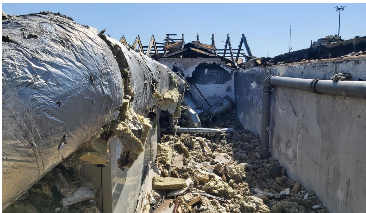
43 pav. Stogo fragmento tarp ašių nuo „1“ iki „2“ ir nuo „C“ iki „D“ laikančiosios konstrukcijos pažeistos 100 %, stogo danga pažeista 100 %, sugadintos inžinerinės sistemos
