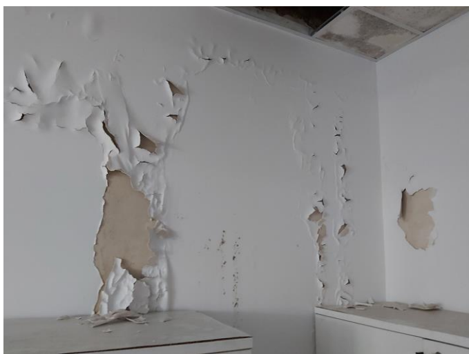
98 pav. Pirmojo aukšto patalpos sienos vaizdas: dėl drėgmės yra nusilupę sienos dažai, pakabinamų lubų apdailinės plokštės yra drėgnos
