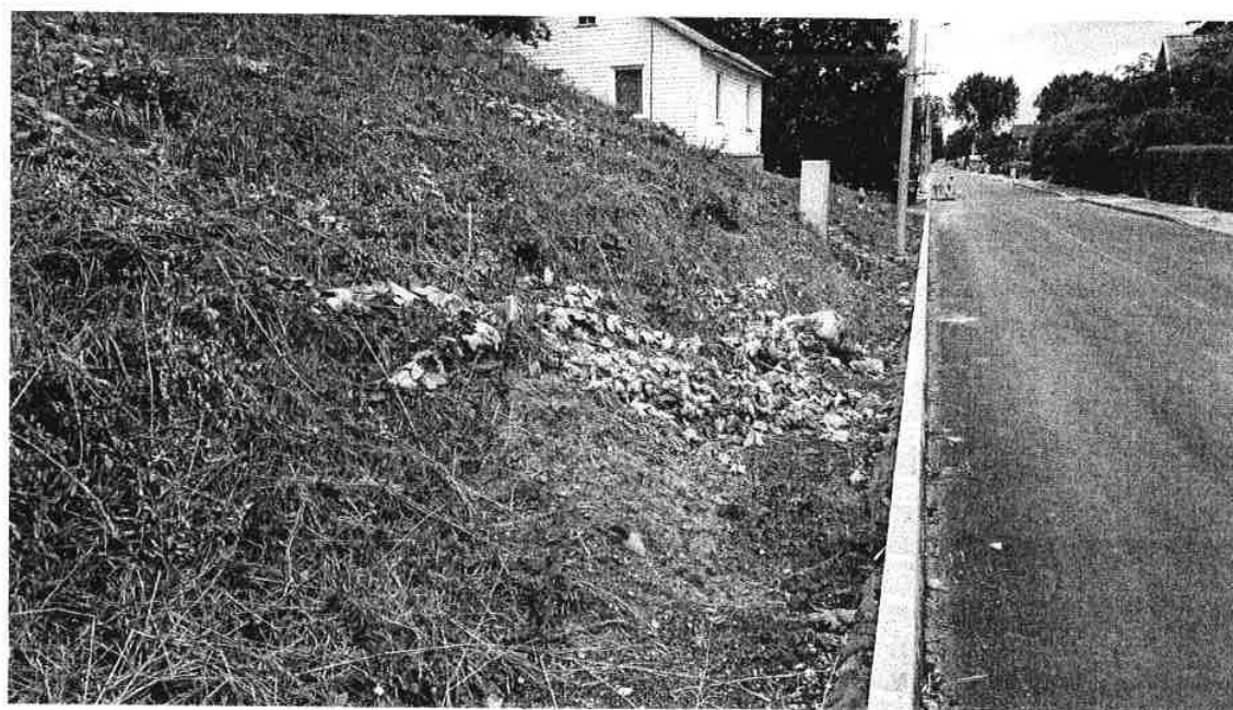
Seinų gatvė PK6+82 – PK7+43 dešinėje kelio pusėje netelpa šaligatvis
