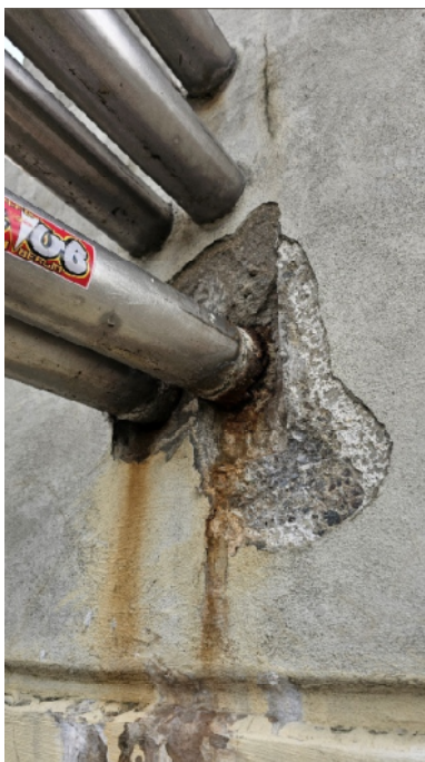
paveikslas 6 Apdailinių vamzdžių pilonuose tvirtinimo pažeidimai
