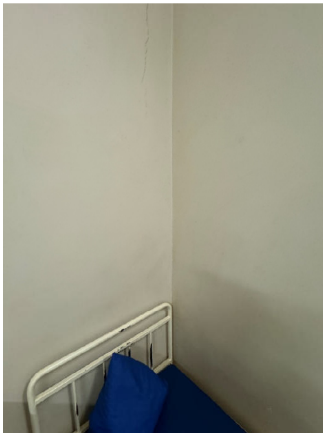
Areštinės patalpose sienose fiksuojami vertikalūs įtrūkiai
