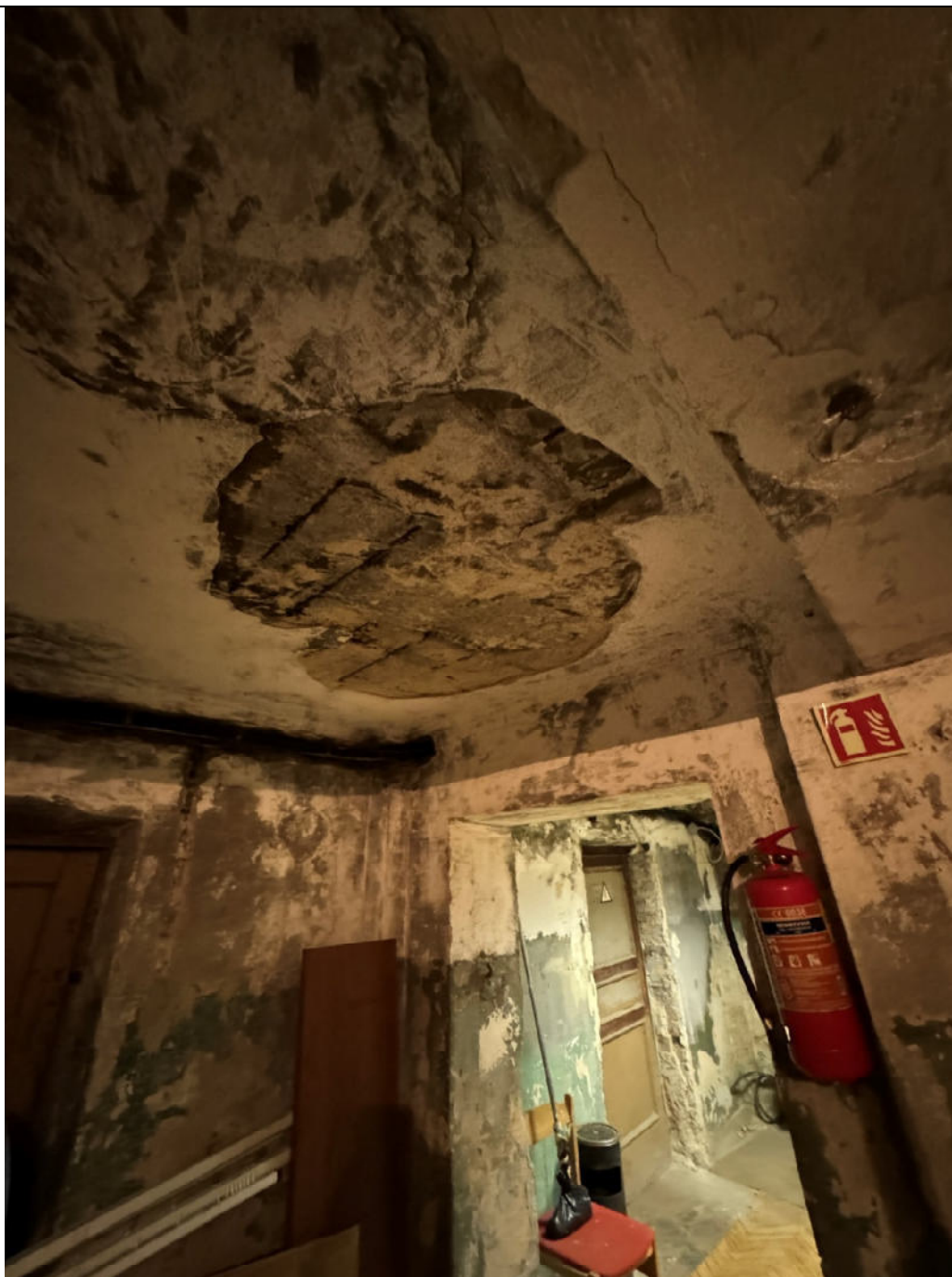
Pusrūsio patalpose fiksuojama pažeista korozijos perdangos armatūra
