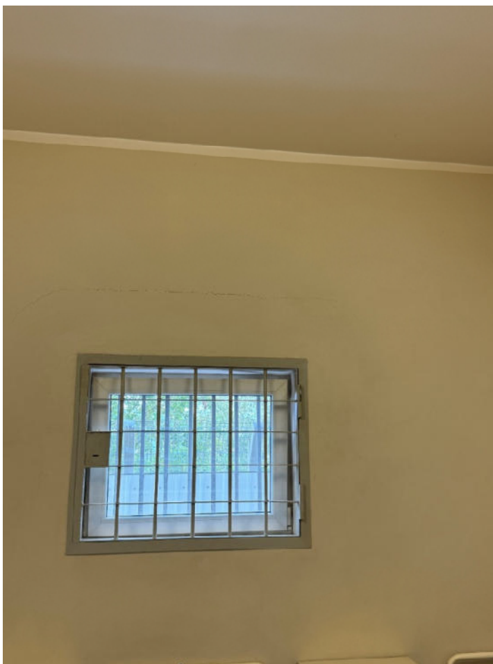
Areštinės patalpose sienose fiksuojami horizontalūs įtrūkiai (Patalpa 1-58)
