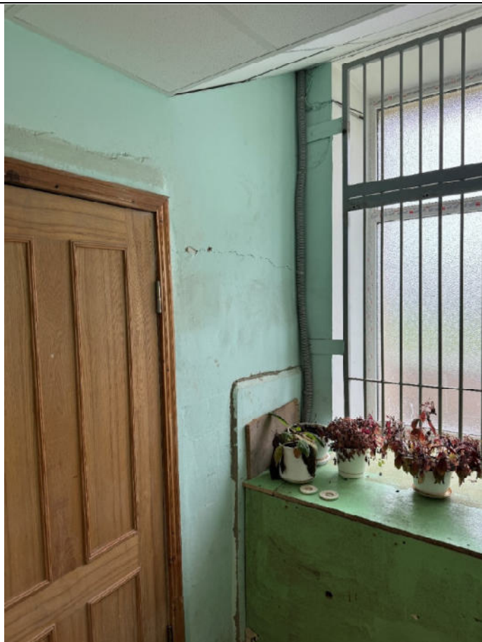
Pirmo aukšto patalpose fiksuojama horizontalūs įtrūkiai
