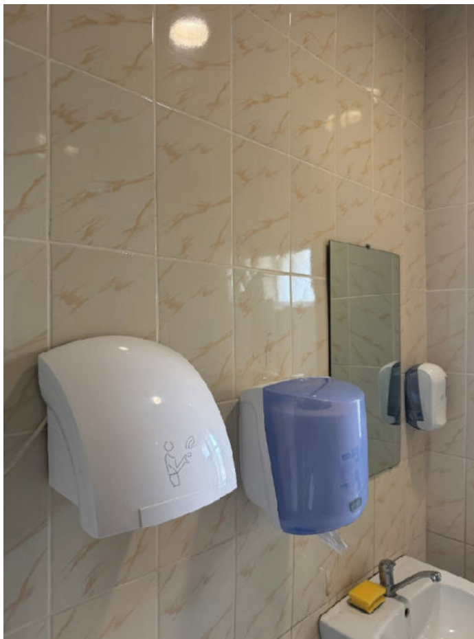
Antro aukšto patalpose apdailoje fiksuojami įtrūkiai (Patalpa 2-34)
