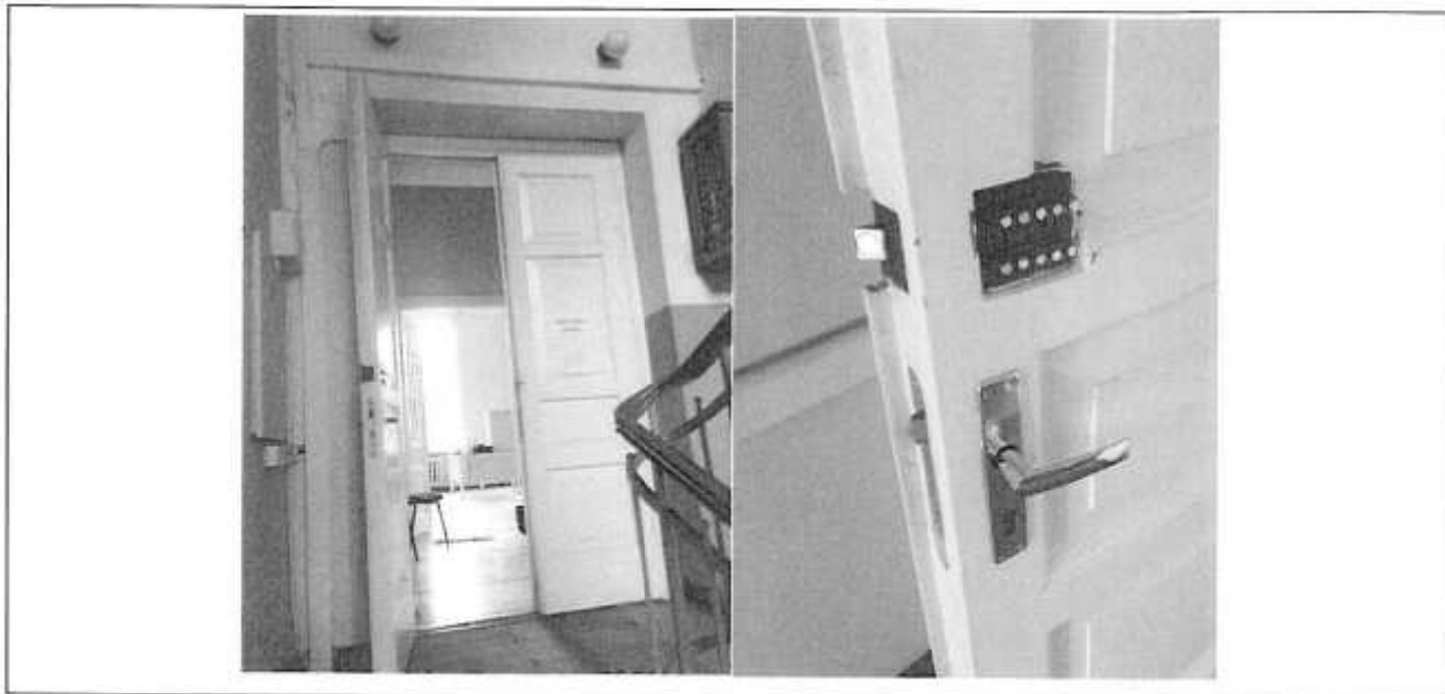
10 pav. Medinių durų su kodine spyna esamos būklės fotografacija
