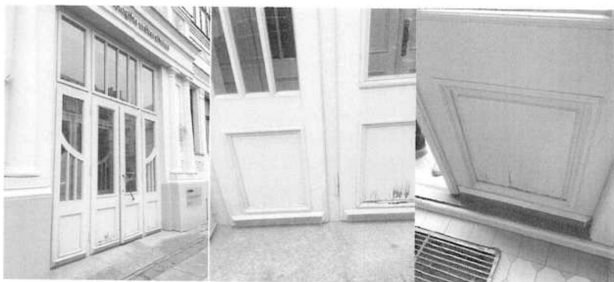
1 pav. Pagrindinio įėjimo durų esamos būklės fotografacija
