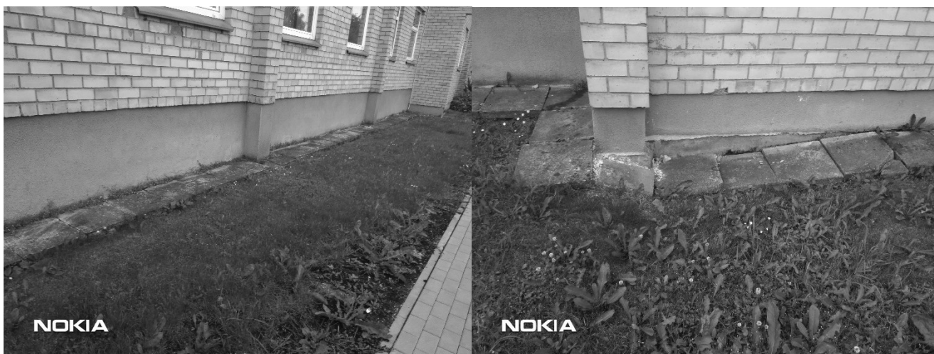
3 pav. Sukritusi betono plytelių nuogrinda.
