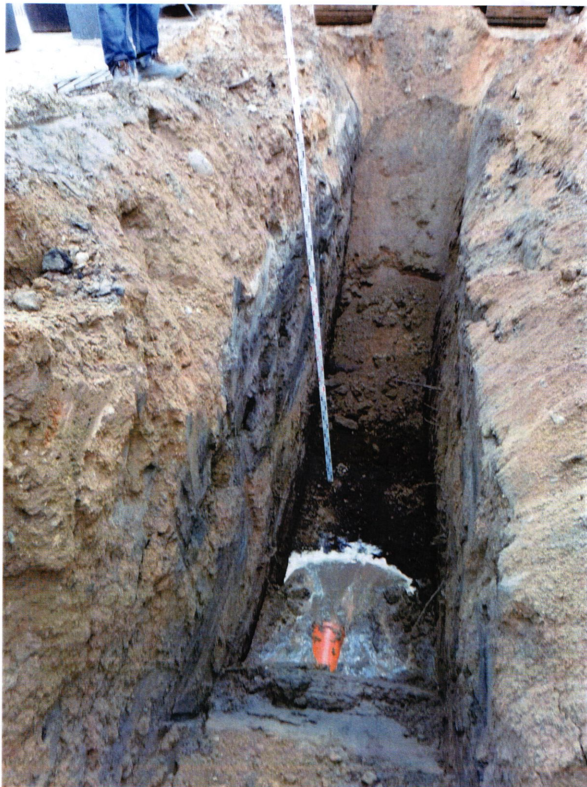
Grunto fotofiksacija kairėje kelio pusėje nuo PK: 3+20 iki PK: 3+38
